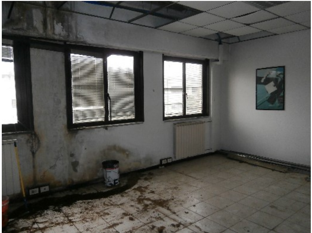
Foto 13: Vista Vano 2, con parete oggetto di infiltrazione attiva dal tetto
