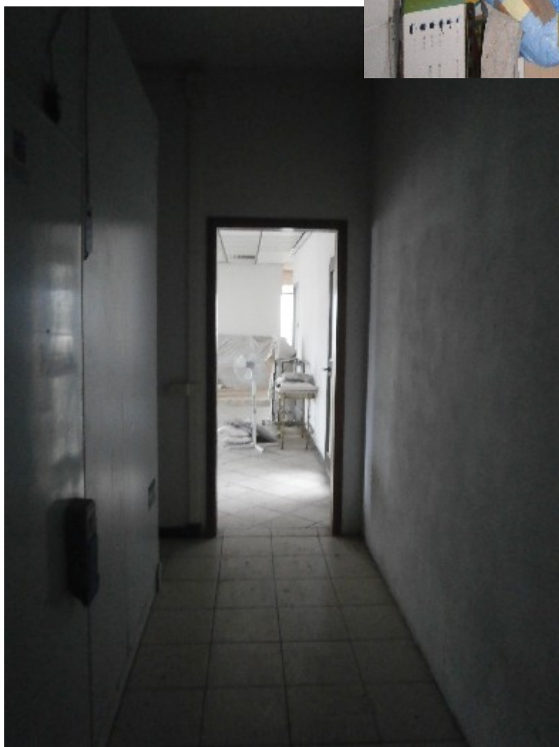
Foto 12: Vista Vano 1 con porta da chiudere, perchè si accede su altra unità immobiliare non oggetto di nostro pignoramento
