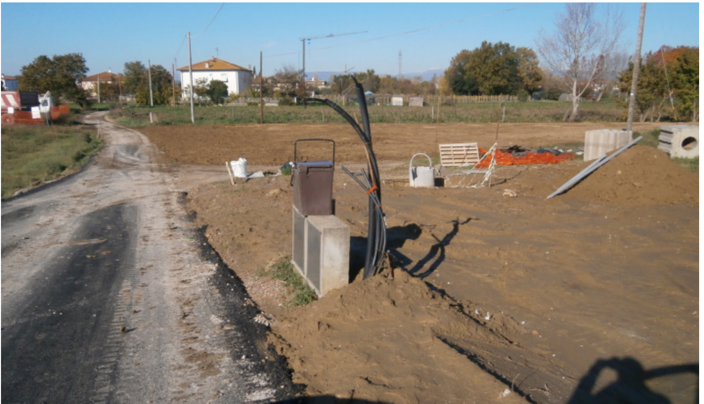
e2- Vista della diramazione di Via L. Banti, che arriva all'aggregato (alle spalle); si notano i contatori dell'acquedotto
