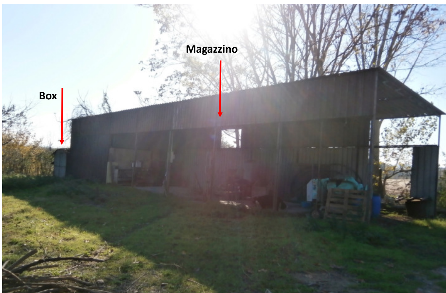
t7– Part. 611 Il Magazzino non autorizzato, e in fondo, il box; entrambi da rimuovere
