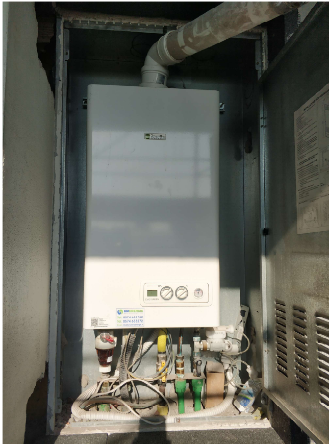
5 Caldaia (da Sostituire intervento 110%)
