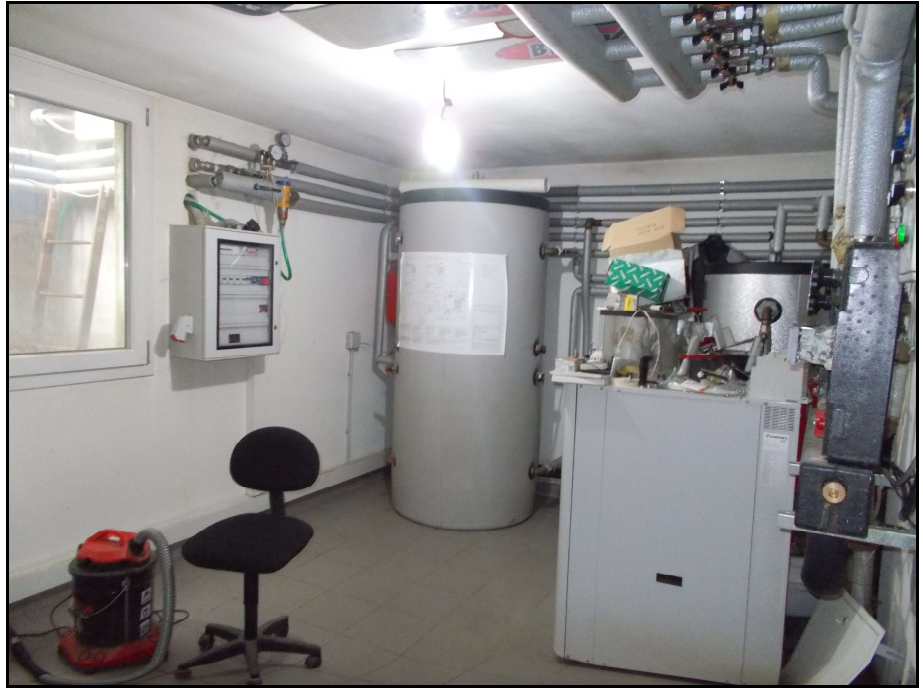
Foto 11-- LOTTO 2- P. Interrato.- Centrale Termica
