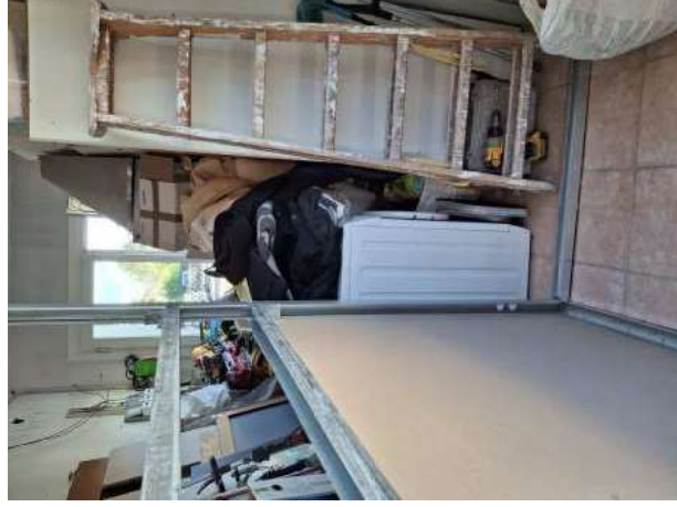
Foto 11 – locale tecnico comune (grezzo avanzato)
