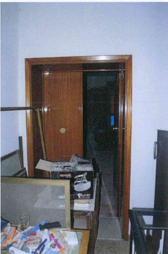
34. Piano primo vano scala comune agli appartamenti 3-4-5. Porta di ingresso all'appartamento 5 (da modificare)
