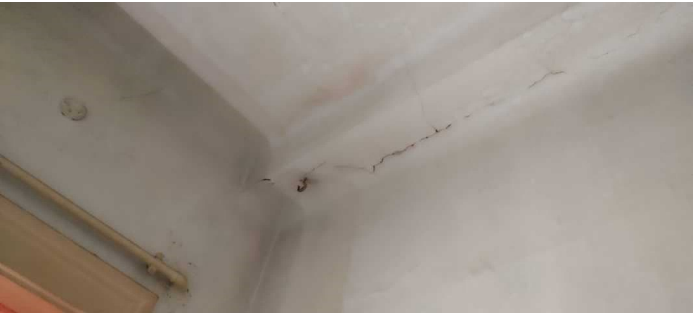
particolare soffitto bagno
