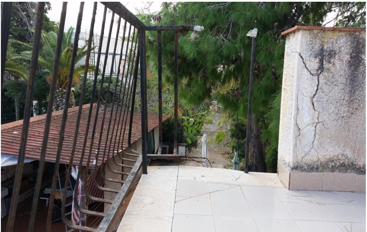
Particola dei parapetti in ferro corrosi
