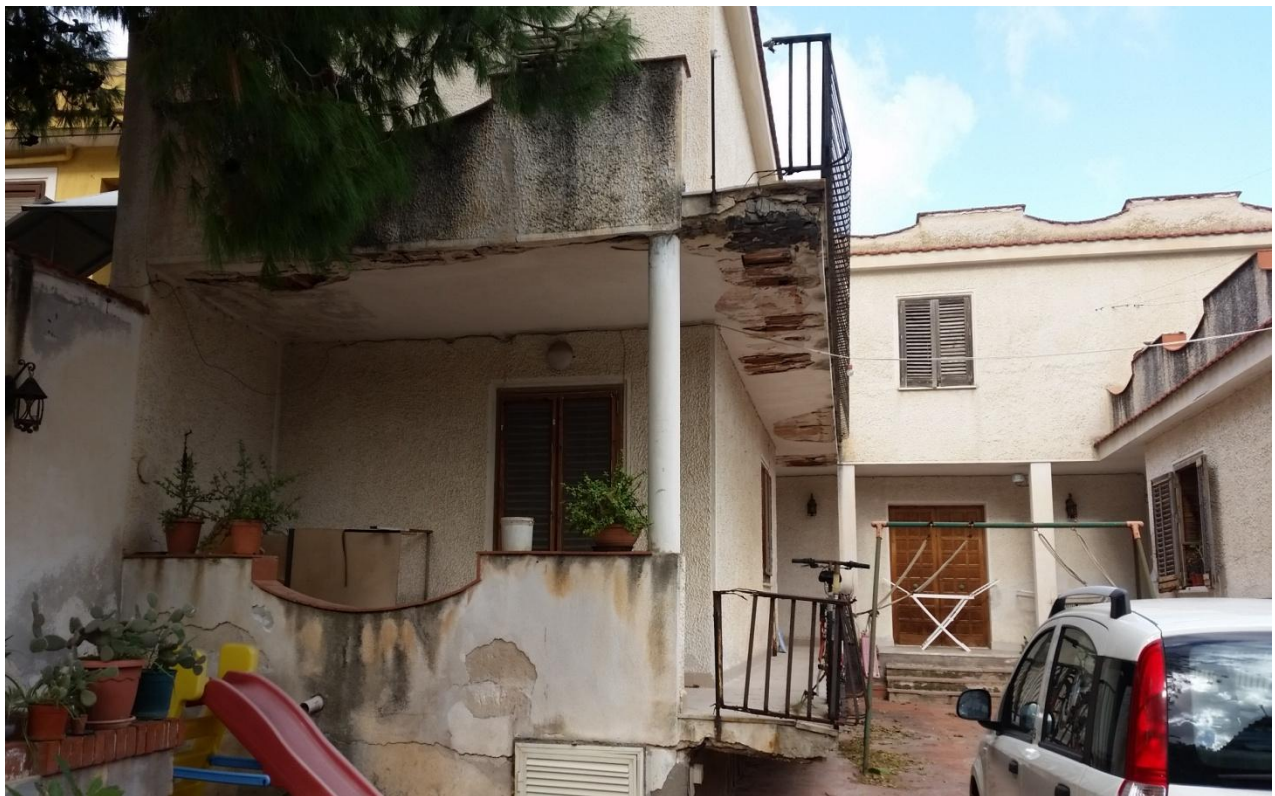
Terrazzino stanze a piano terra – balconi ammalorati
