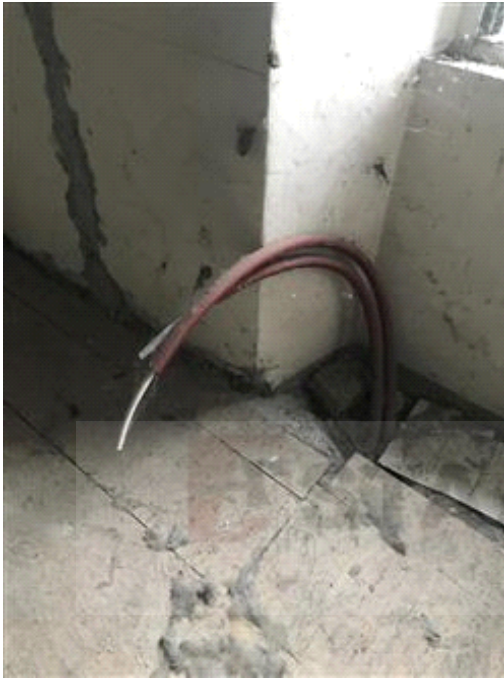
Impianto di riscaldamento
