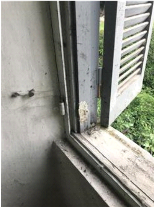
Sistema di oscuramento infissi esterni
