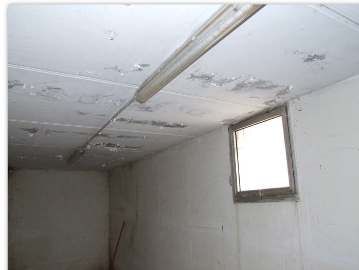
12. Particolare delle infiltrazioni
