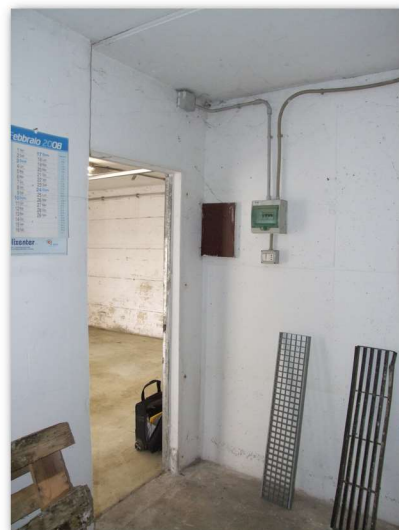
11. Particolare dell'impianto elettrico
