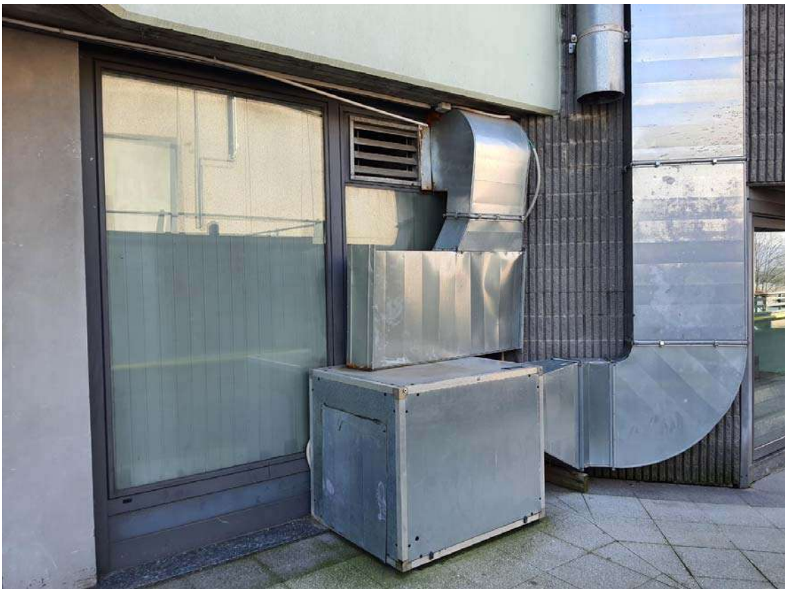
RILIEVO ESTERNO – Sub. 715 – Foto 19 e 20. Dettagli gruppo esterno condotti dell'impianto di climatizzazione e ricircolo aria del locale.
