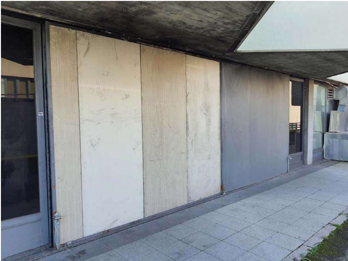
RILIEVO ESTERNO – Sub. 715 – Foto 15. Vista delle pannellature mobili a chiusura dei portali sul fronte Nord.
