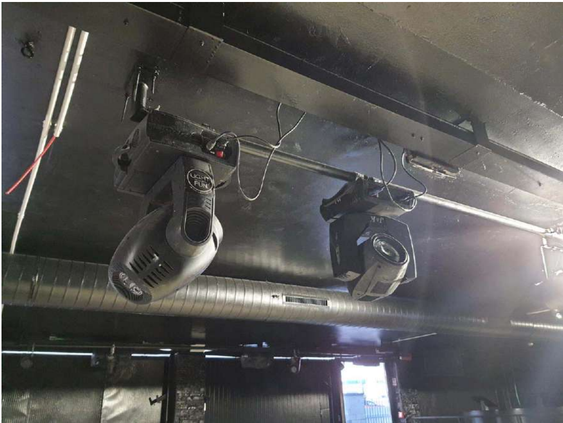
RILIEVO PARTICOLARI – Sub. 715 – Foto 82 e 83. Dettagli dell'impianto audio e illuminante per la sala da ballo.
