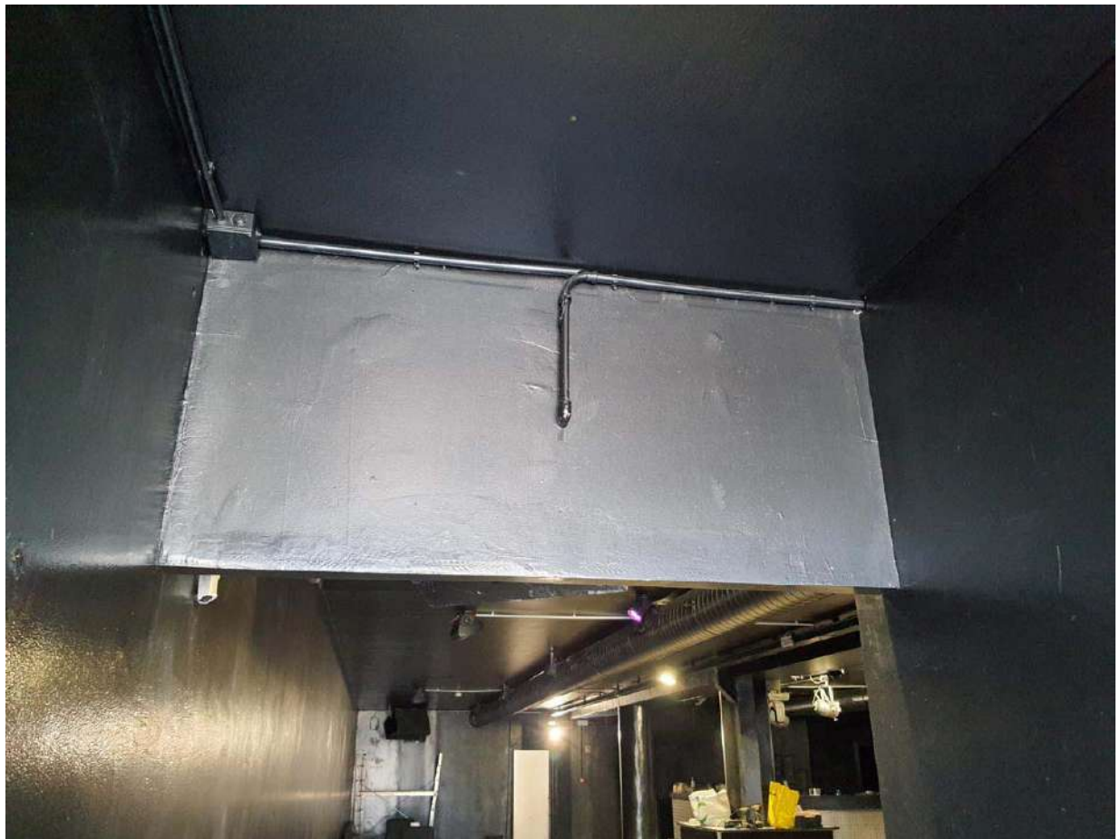
RILIEVO PARTICOLARI – Sub. 715 – Foto 93-95. Dettagli dell'impianto elettrico e canalizzazioni/derivazioni a parete.
