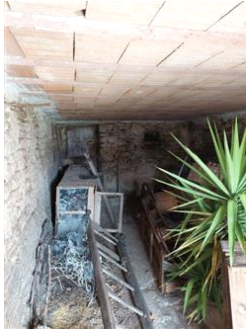
Deposito al PSI
