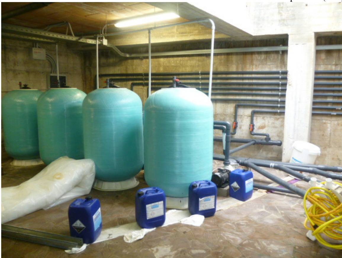
Locali tecnici – depuratori (PS1)
