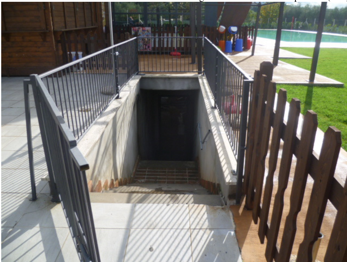
Ingresso locali tecnici – depuratori (PS1)
