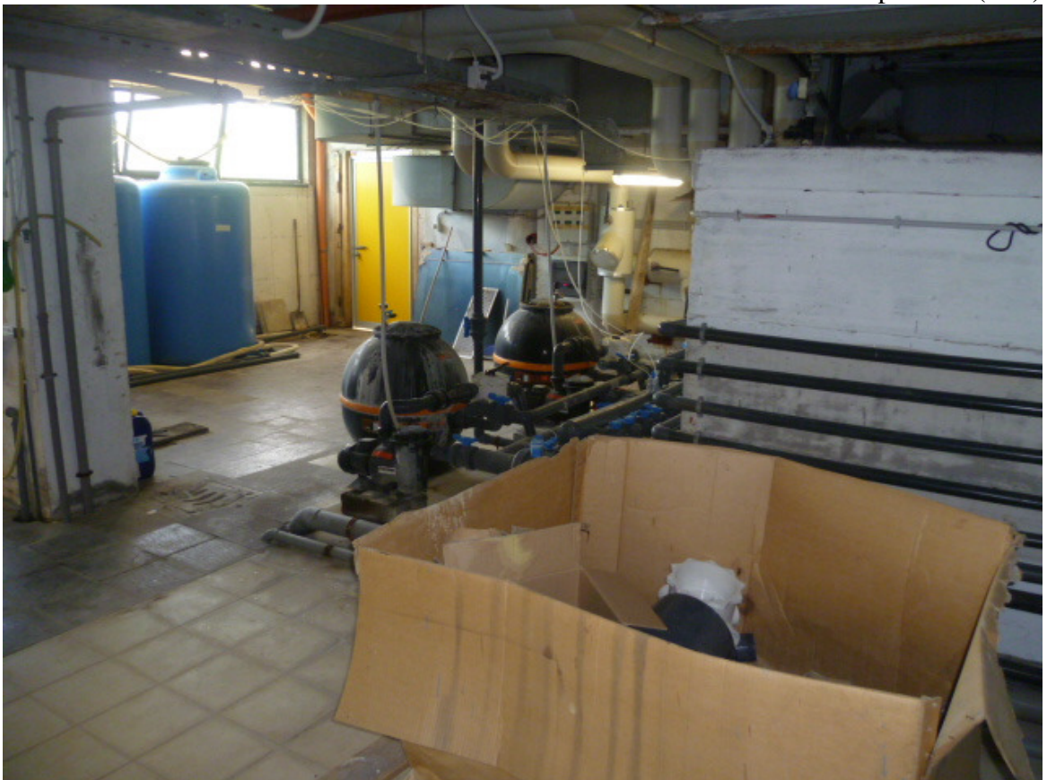
Locali tecnici – depuratori (PS1)
