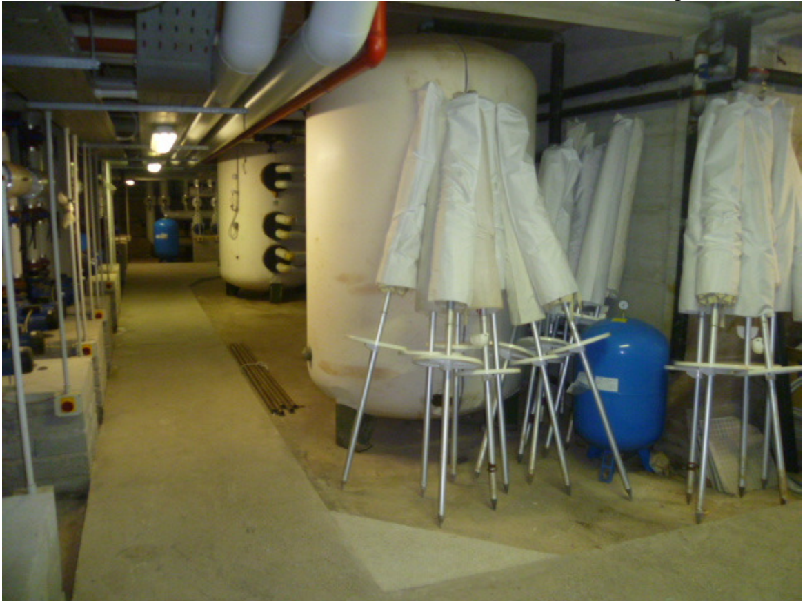
Locali tecnici – depuratori (PS1)
