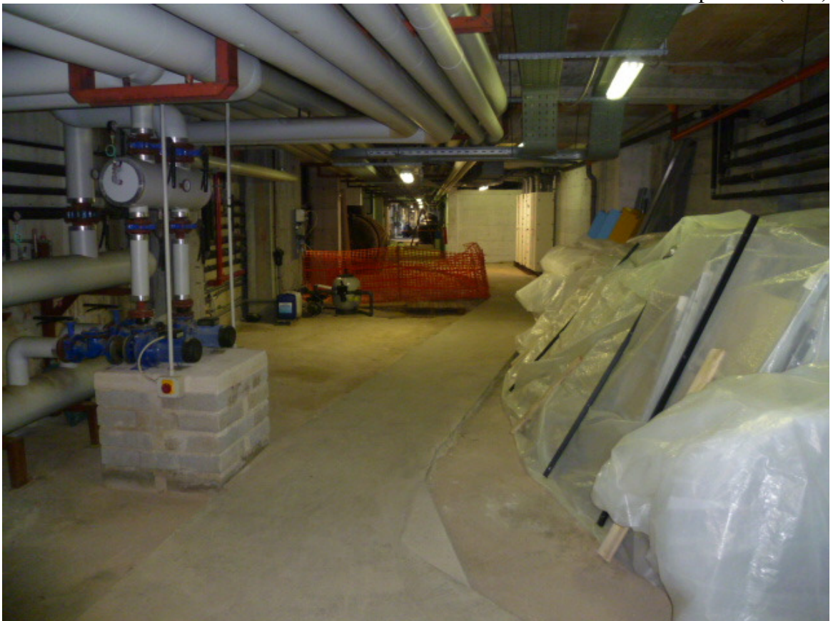
Locali tecnici – depuratori (PS1)
