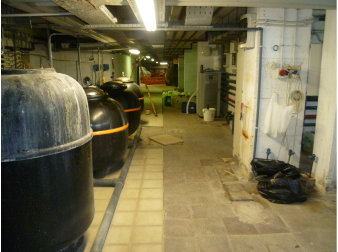
Locali tecnici – depuratori (PS1)
