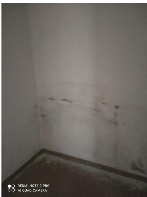
Foto n° 16 – danneggiamento da umidità cameretta appartamento piano terra sub. n. 3 – spigolo con camera – Foto 24.03.2023
