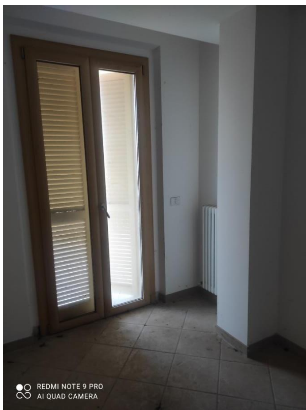
Foto n° 15 – porta finestra cameretta appartamento piano terra sub. n. 3 – Foto 24.03.2023
