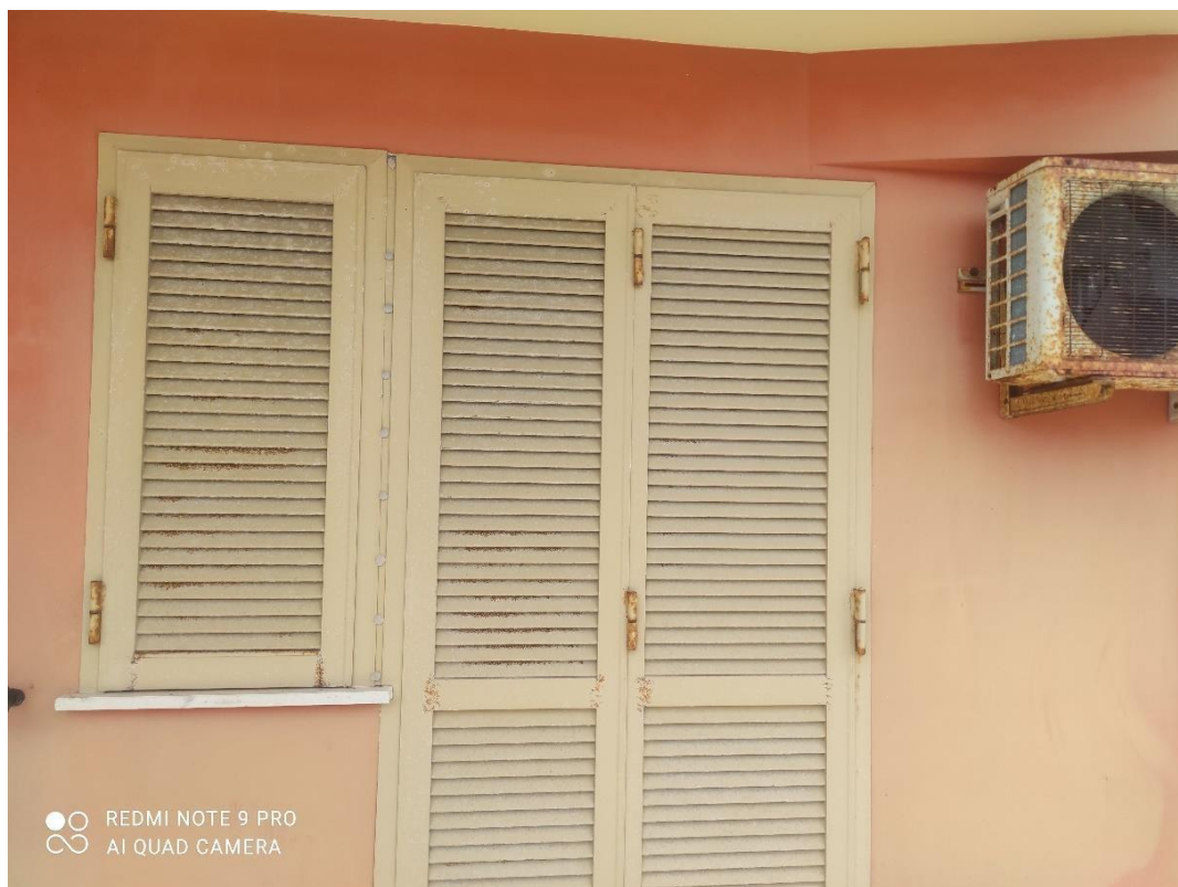
Foto n° 43 – stato di conservazione infissi piano T sub. n. 3 – Foto 30.05.2024
