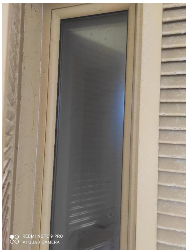
Foto n° 42 – stato di conservazione infissi piano T sub. n. 3 – Foto 30.05.2024
