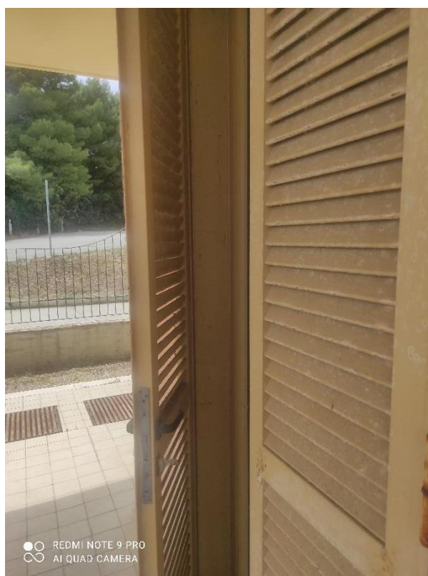
Foto n° 44 – stato di conservazione infissi piano T sub. n. 3 – Foto 30.05.2024
