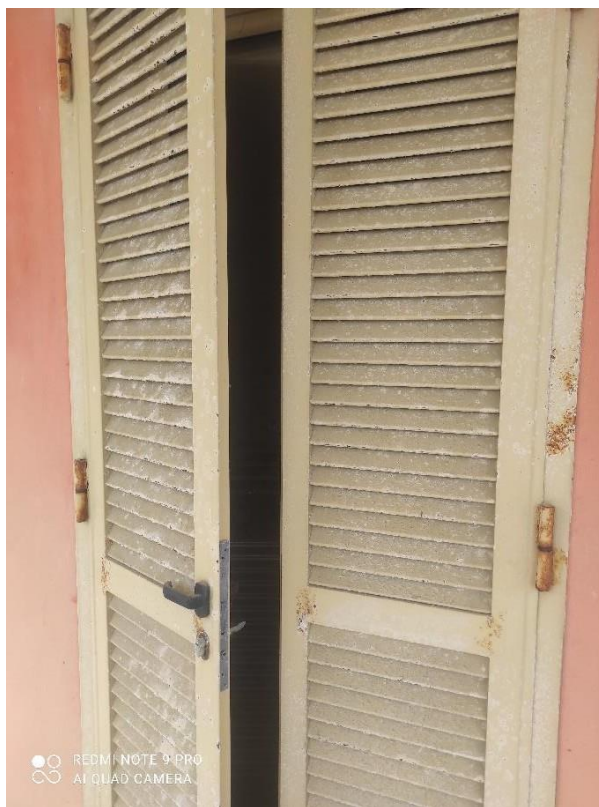
Foto n° 41 – stato di conservazione infissi piano T sub. n. 3 – Foto 30.05.2024
