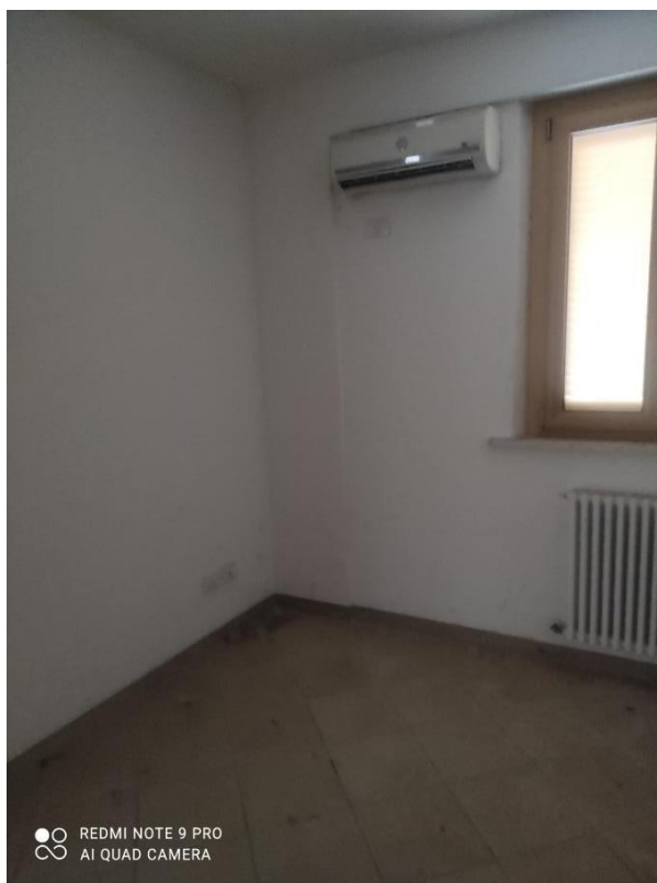
Foto n° 18 – camera appartamento piano terra sub. n. 3 – spigolo con cameretta con presenza di umidità di risalita – Foto 24.03.2023
