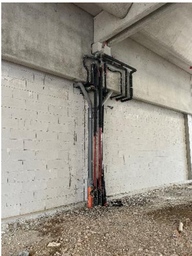
Lotto 2 - Particolare impianti
