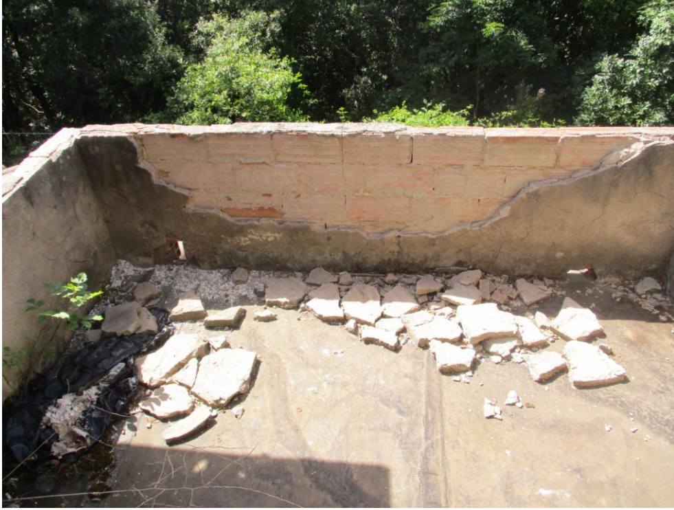
LOTTO 1 – VISTA ESTERNA – BALCONE DETERIORATO
