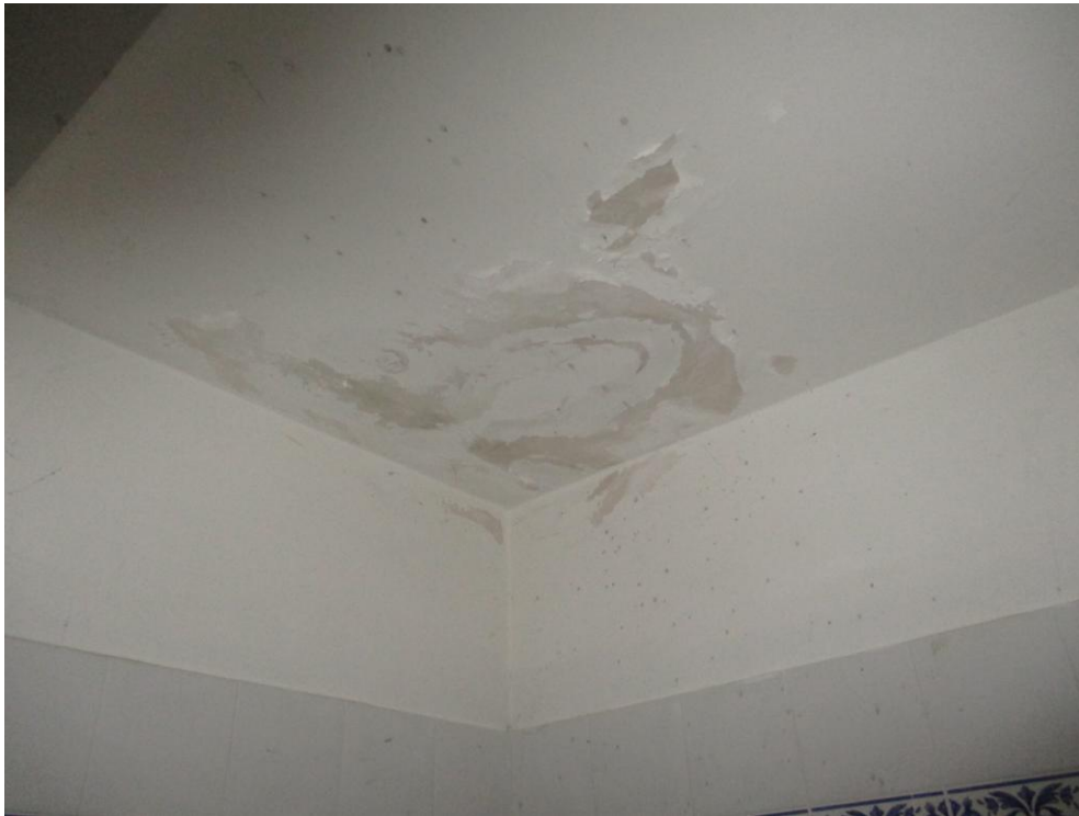
LOTTO 1 – VISTA INTERNA – INFILTRAZIONE BAGNO PIANO TERRA
