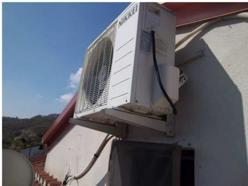
Figura 19 – Climatizzatore posto al Secondo Piano
