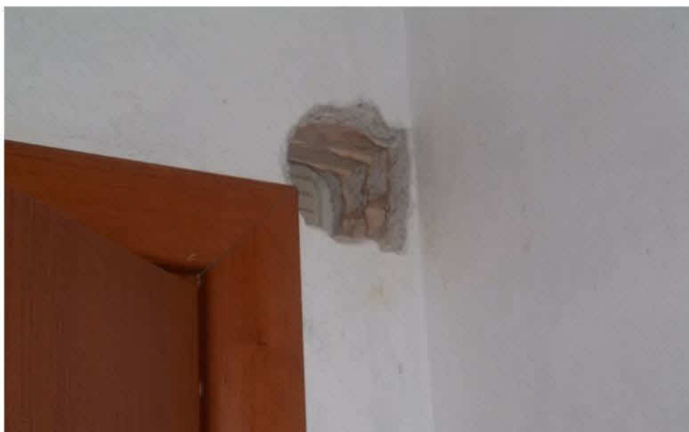
Figura 14 – Fori presenti nelle pareti interne dell'appartamento
