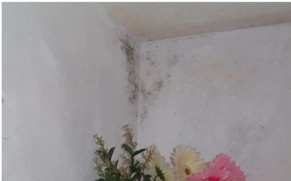
Figura 13 – Evidenti macchie di umidità
