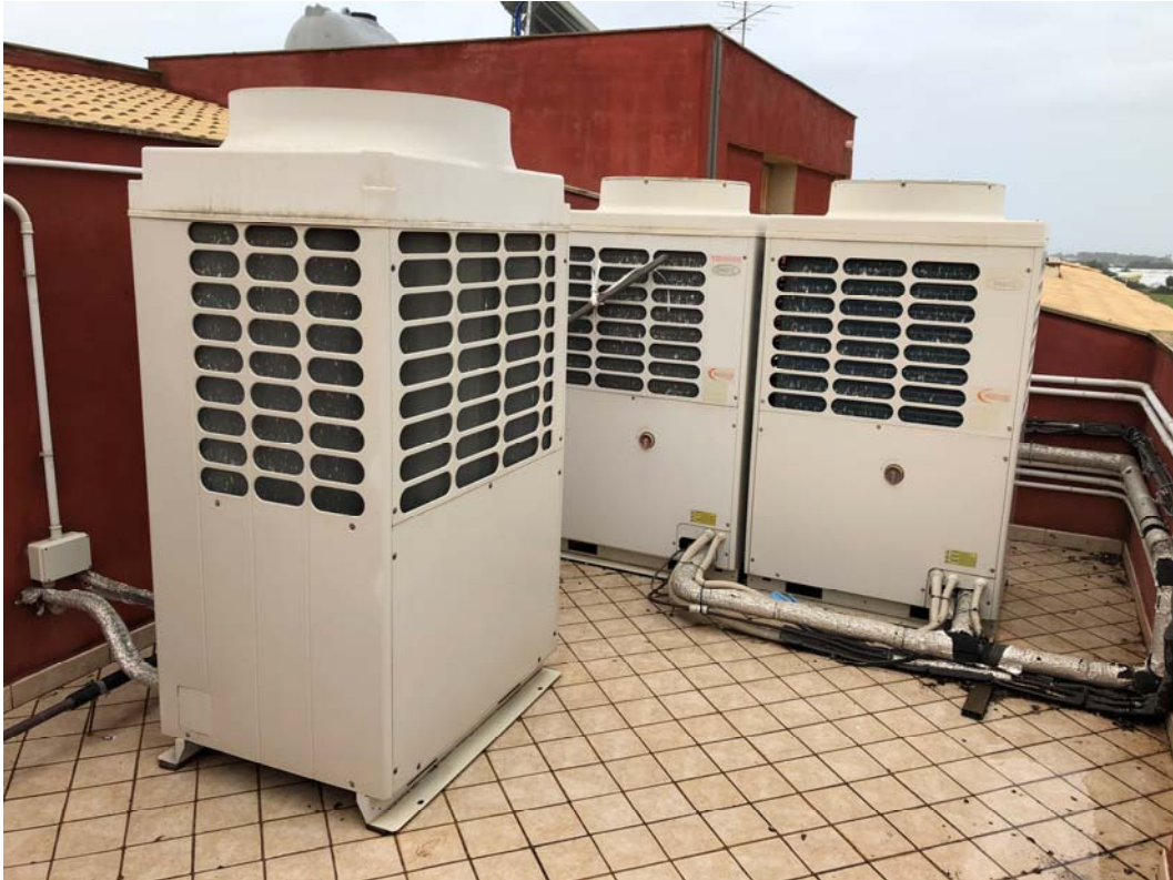
Foto n° 17 – Climatizzatori su terrazzo al secondo piano
