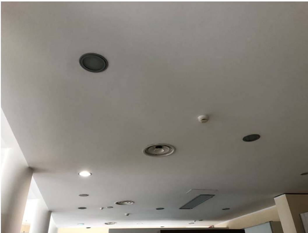
Foto n° 10 – Controsoffitto piano terra
