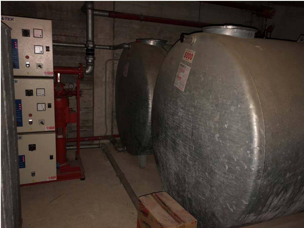
Foto n° 4 – Impianto idrico antincendio
