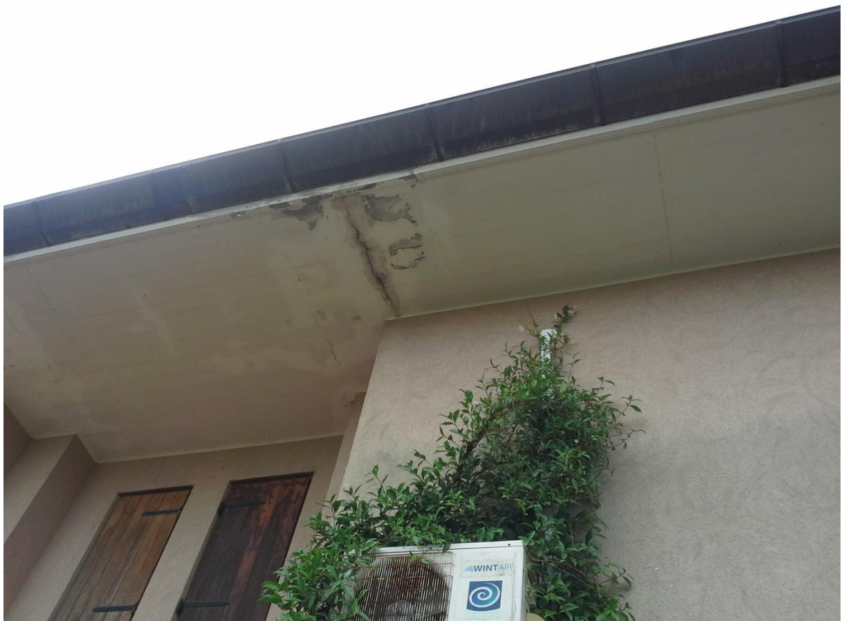
Foto n. 27 – Particolare infiltrazione cornice/canale di gronda
