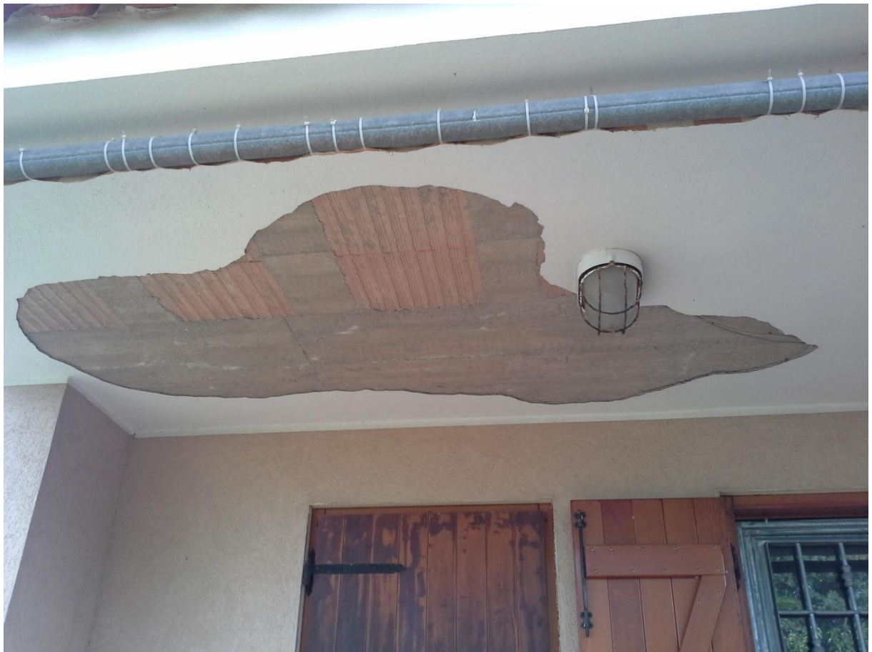
Foto n. 38 – Particolare del distacco di intonaco dal soffitto nell'area antistante l'ingresso al villino
