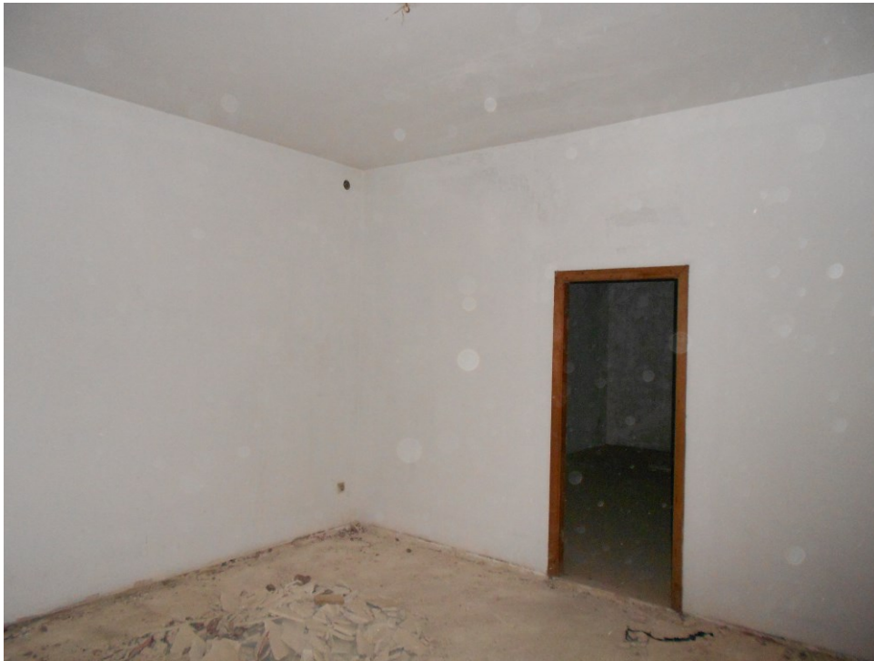
Foto n ° 11 – Vista del vano di cui alla foto n° 10, ripresa da altra angolazione.
