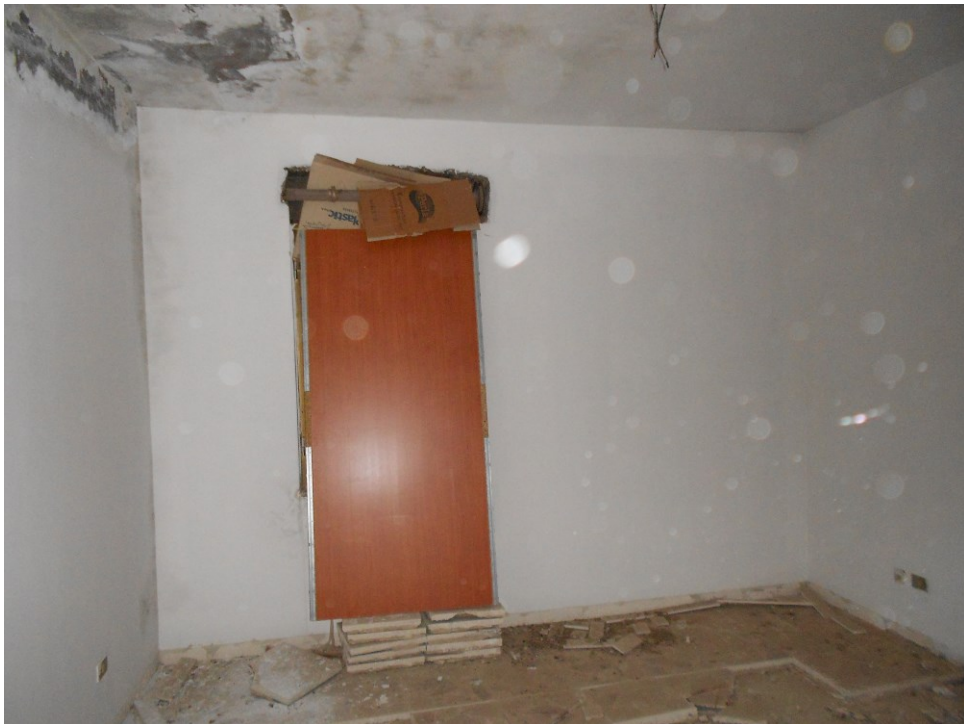
Foto n ° 6 – Vano adiacente il locale WC.
