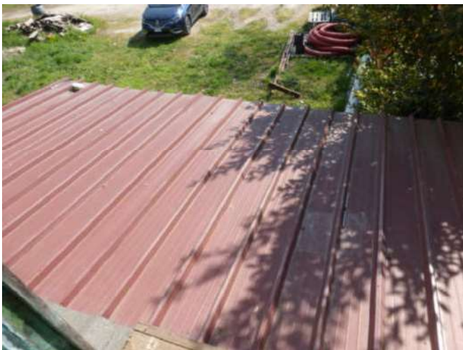
copertura illegittima corte
