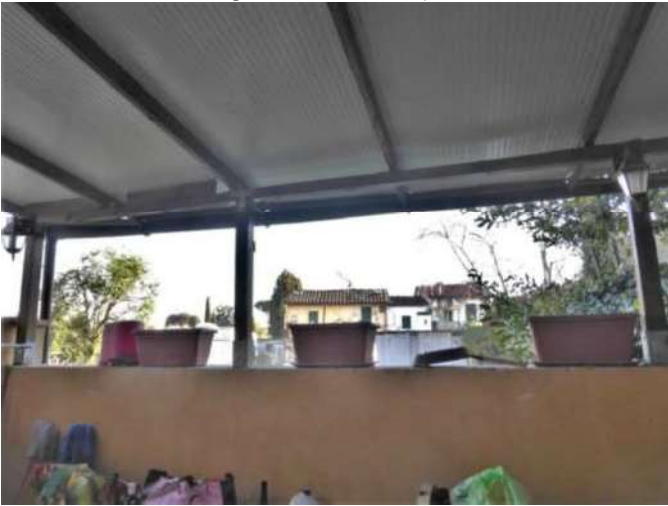
locale 5 - corte illegittimamente coperta
