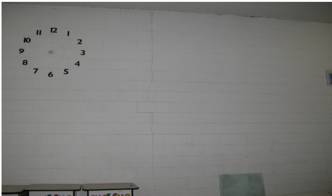
Foto Z1-2/ 8695-96 Lesione subverticale e sconnessione del giunto verticale
