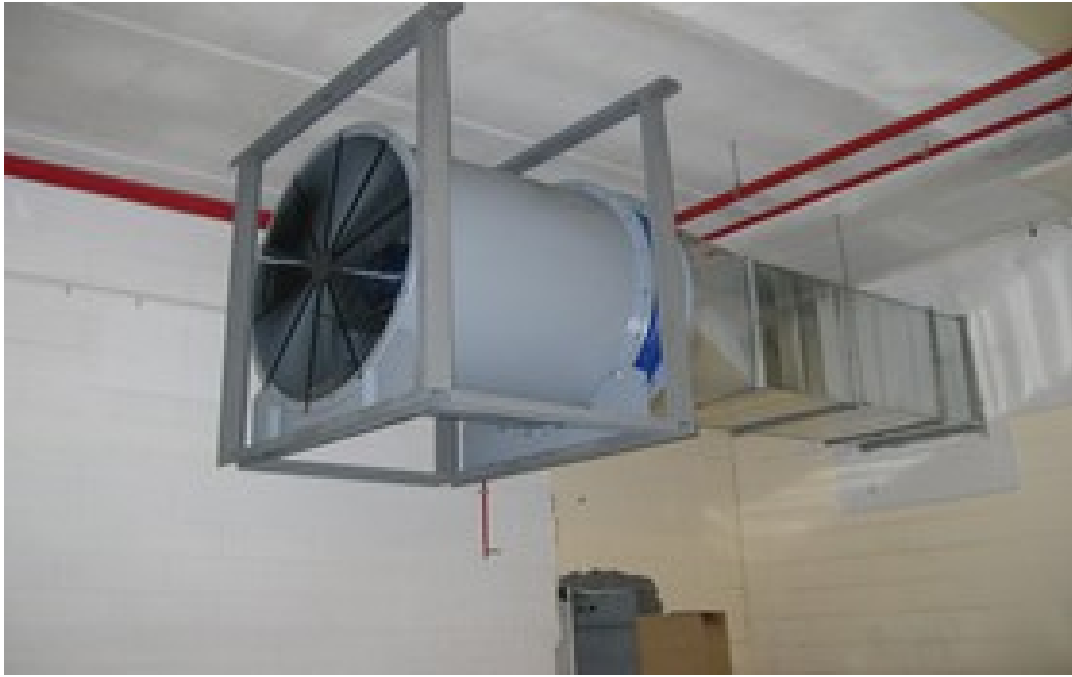
Foto U/8698 Ventilatore di aspirazione aria
