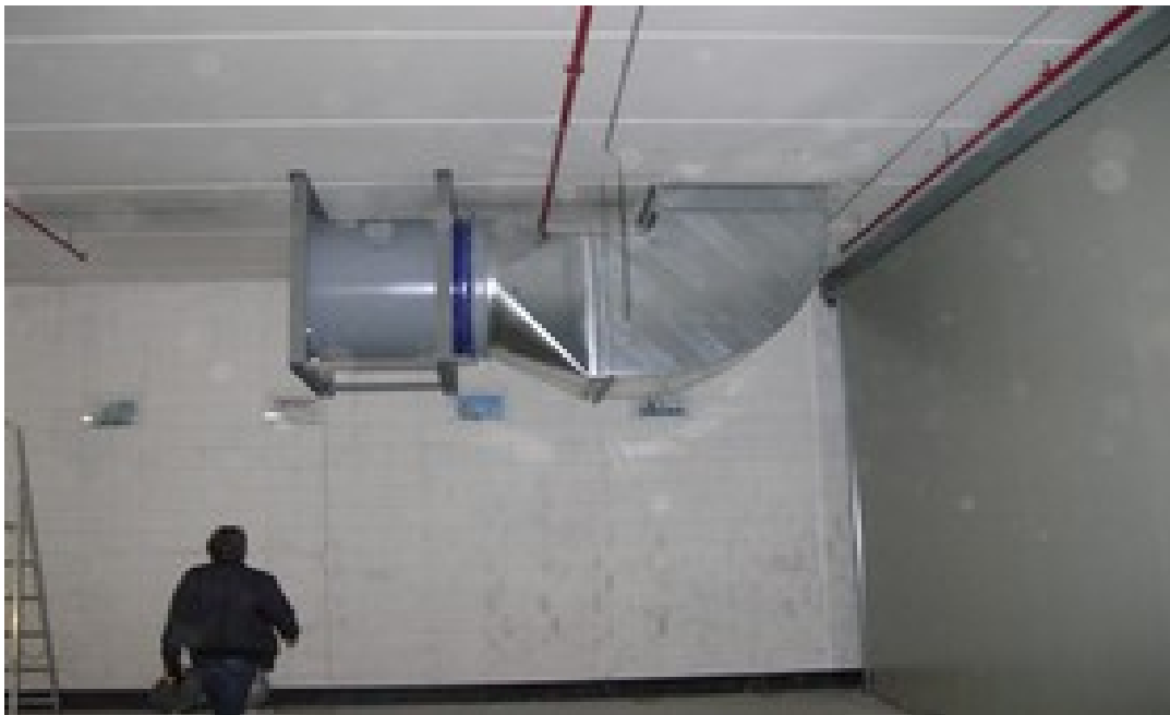
Foto V/8691 Ventilatore di espulsione aria
