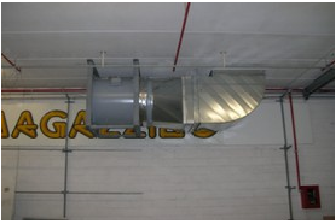
Foto N/8689 Ventilatore di espulsione aria
