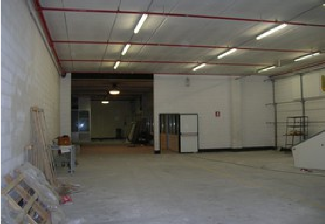
Foto E/8636 Interno lato ingresso con vista impianto sprinkler
