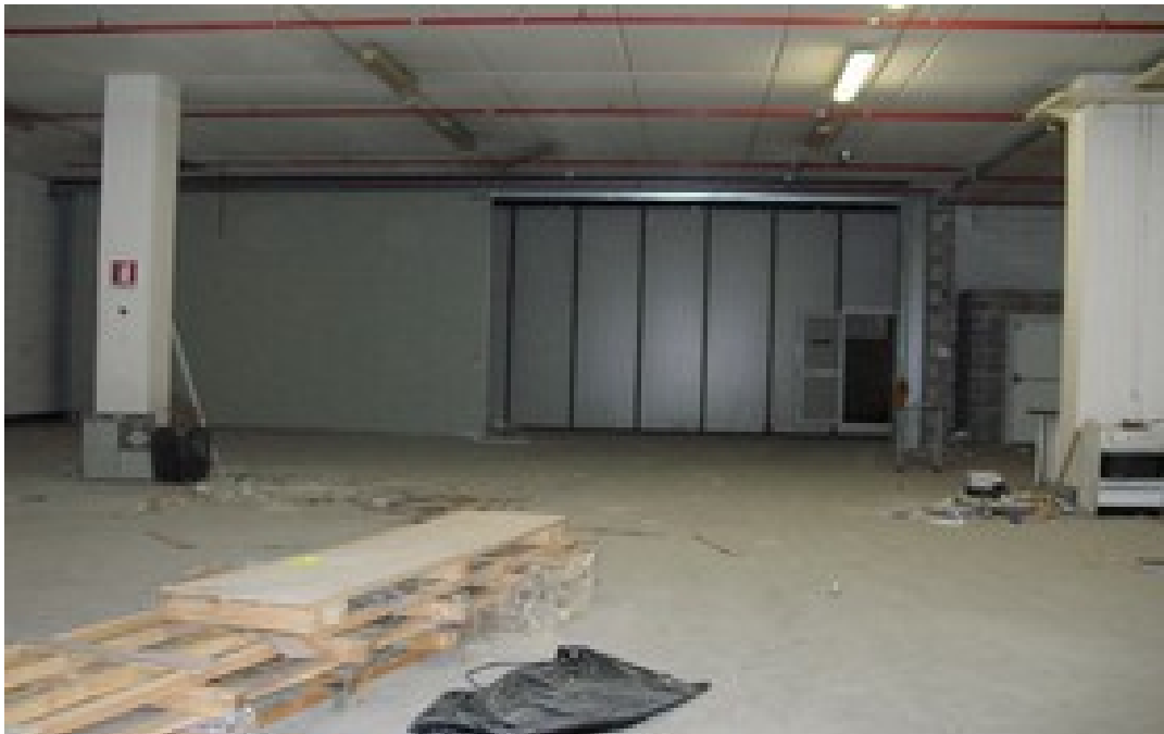
Foto P/8479 Ingressi pedonali e portoni esterno e interno interno a prova di fumo
