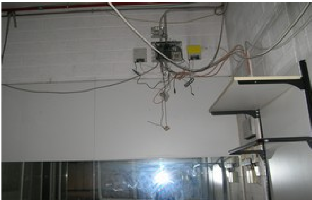
Foto I-L/8438-8440 Impianto elettrico manomesso
