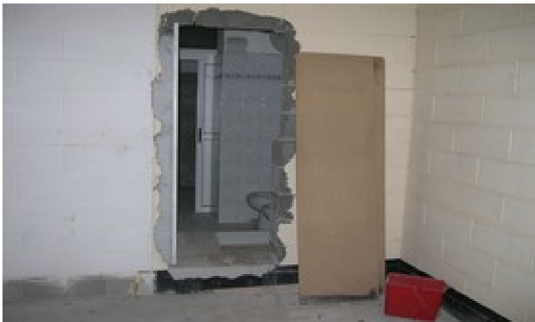
Foto S/8473 Servizio del Lotto I messo in comunicazione col Lotto 2
