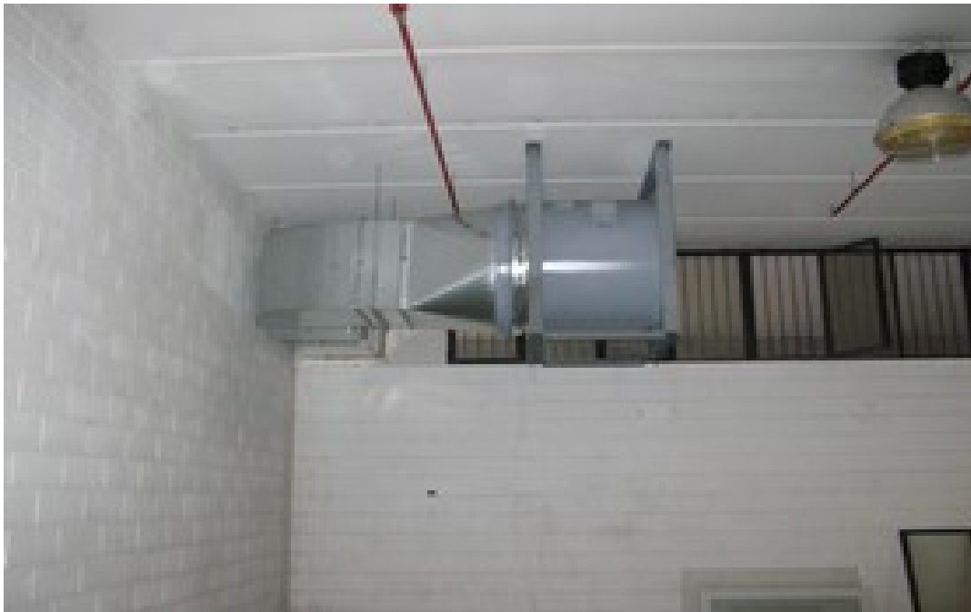
Foto M/8686 Finestrature lato est e ventilatore di immissione aria
