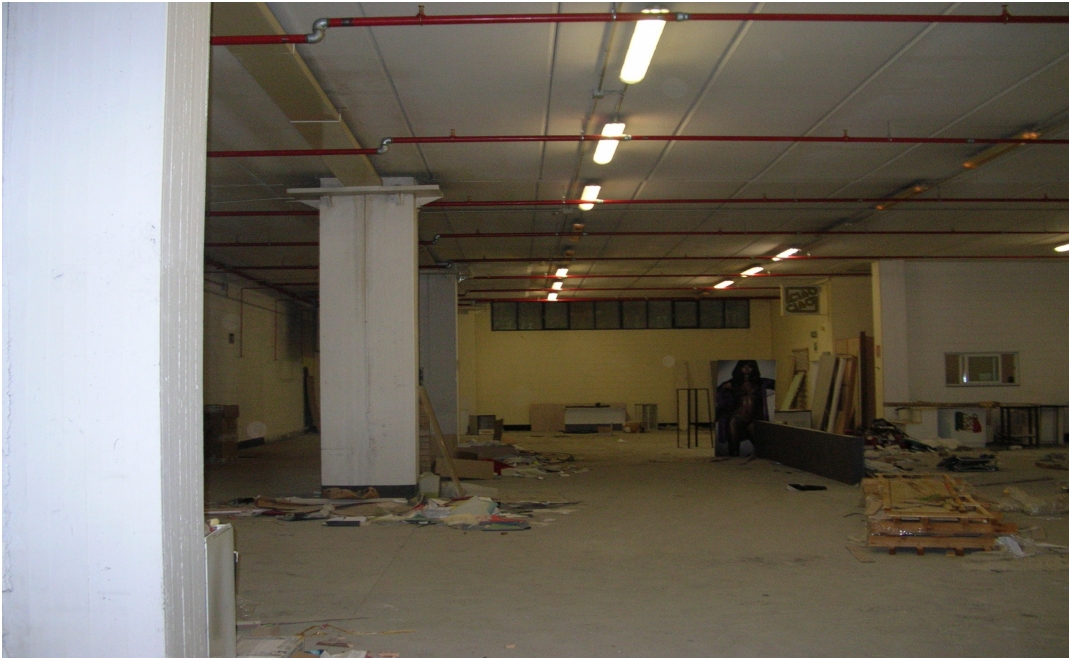
Foto Q/8478 Interno con impianto sprinkler e compartimentazioni
