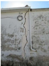
Foto 10 – Veduta lesione fabbricato
