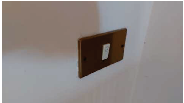
foto nr.40: particolare impianti
