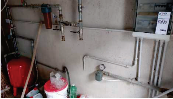
foto nr.69: vista interna locale tecnico
