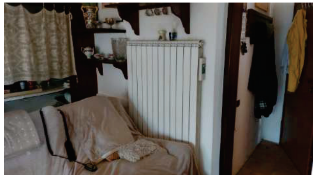
foto nr.44: particolare impianti
