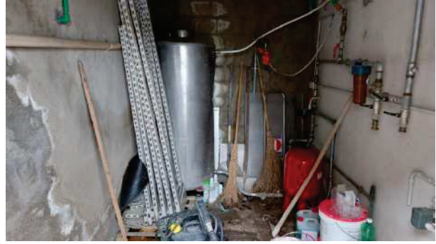
foto nr.70: vista interna locale tecnico
