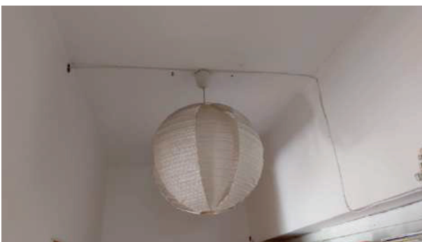
foto nr.35: particolare impianti
