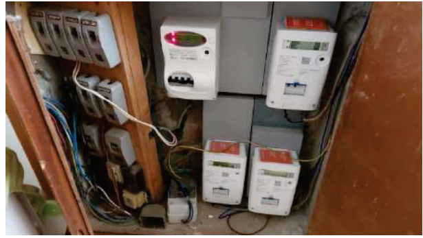
foto nr.46: particolare impianti
