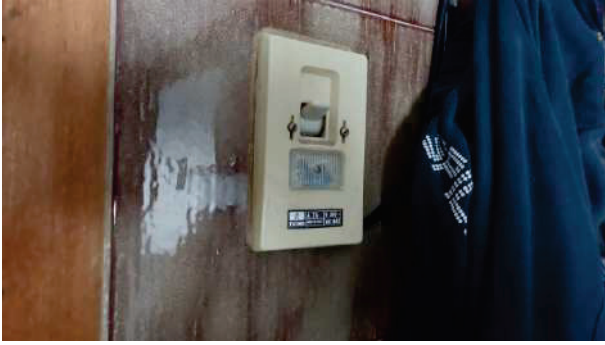
foto nr.37: particolare impianti
