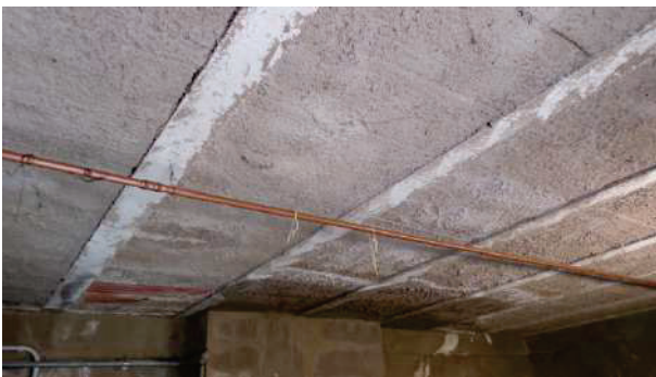
foto nr.73: particolare interno locale tecnico
