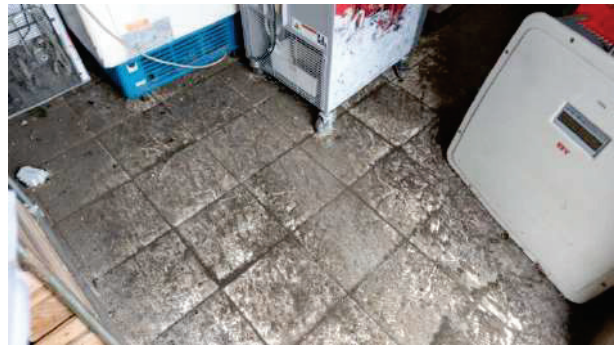
foto nr.72: particolare interno locale tecnico
