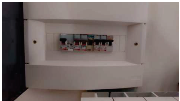
foto nr.42: particolare impianti
