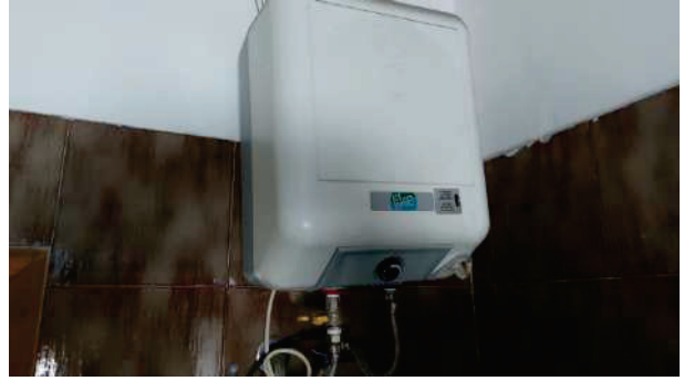
foto nr.38: particolare impianti
