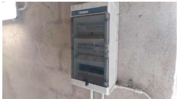
foto nr.74: particolare interno locale tecnico
