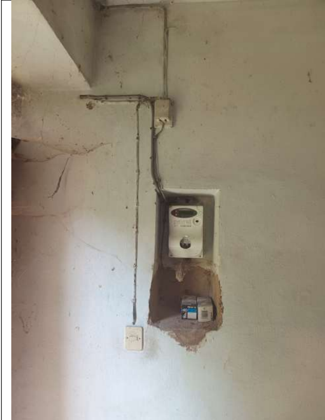
Foto 21 _Tipologia di impianto elettrico e quadro
