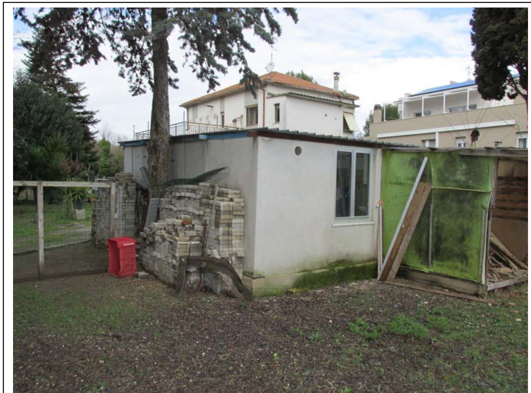
TERRENO (PARTIC 76) CON MANUFATTI ABUSIVI
