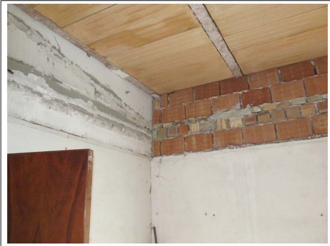
PIANO TERRA (AMPLIAMENTO ABUSIVO)
