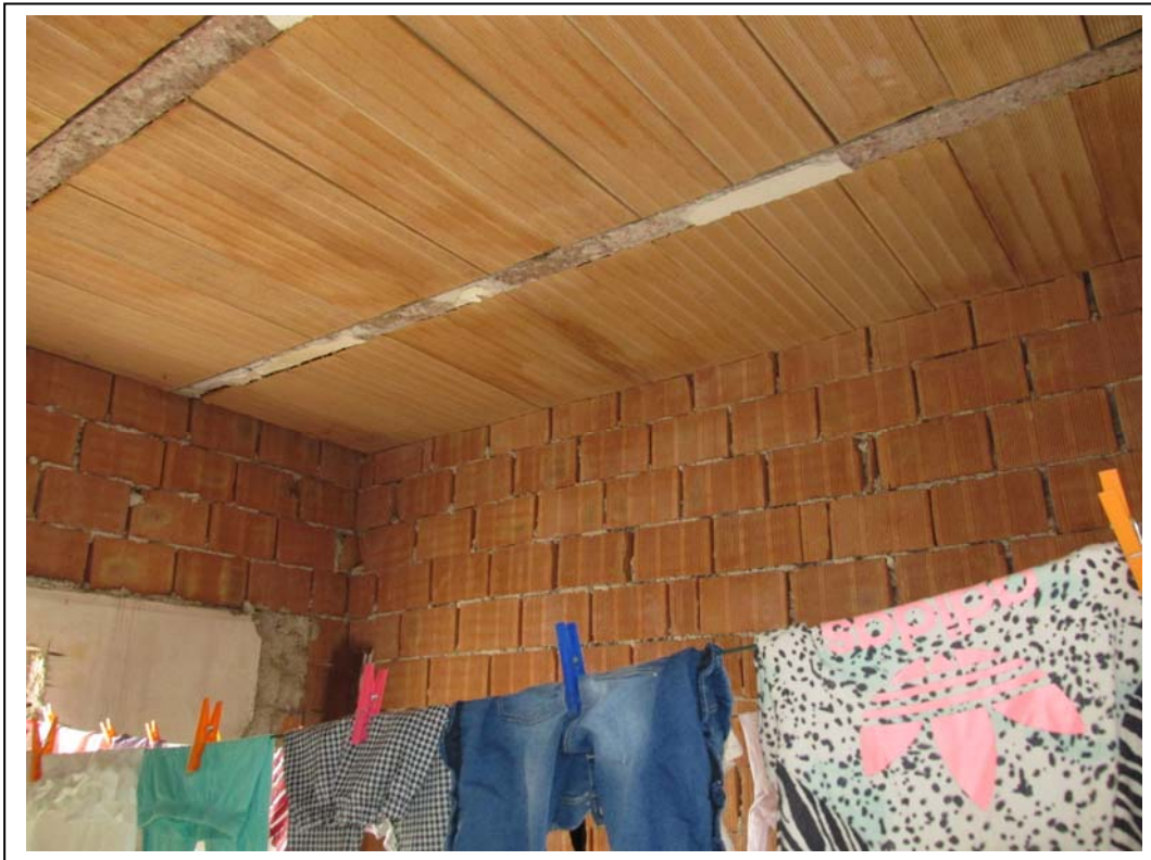
PIANO TERRA (AMPLIAMENTO ABUSIVO)
