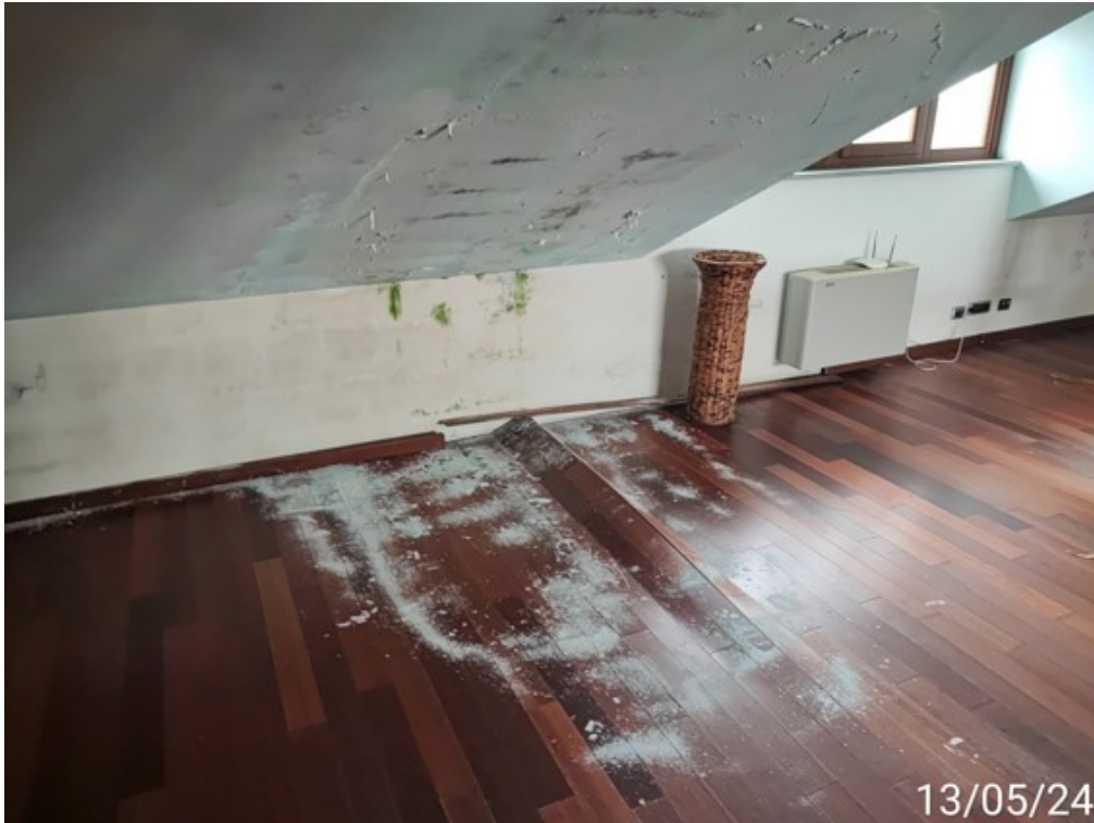
Fotografia E.17 - 18 Particolare infiltrazioni sottotetto
