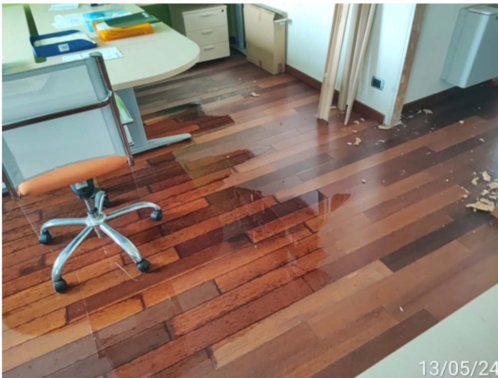
Fotografia E.20 - 21 Pavimento in legno allagato
