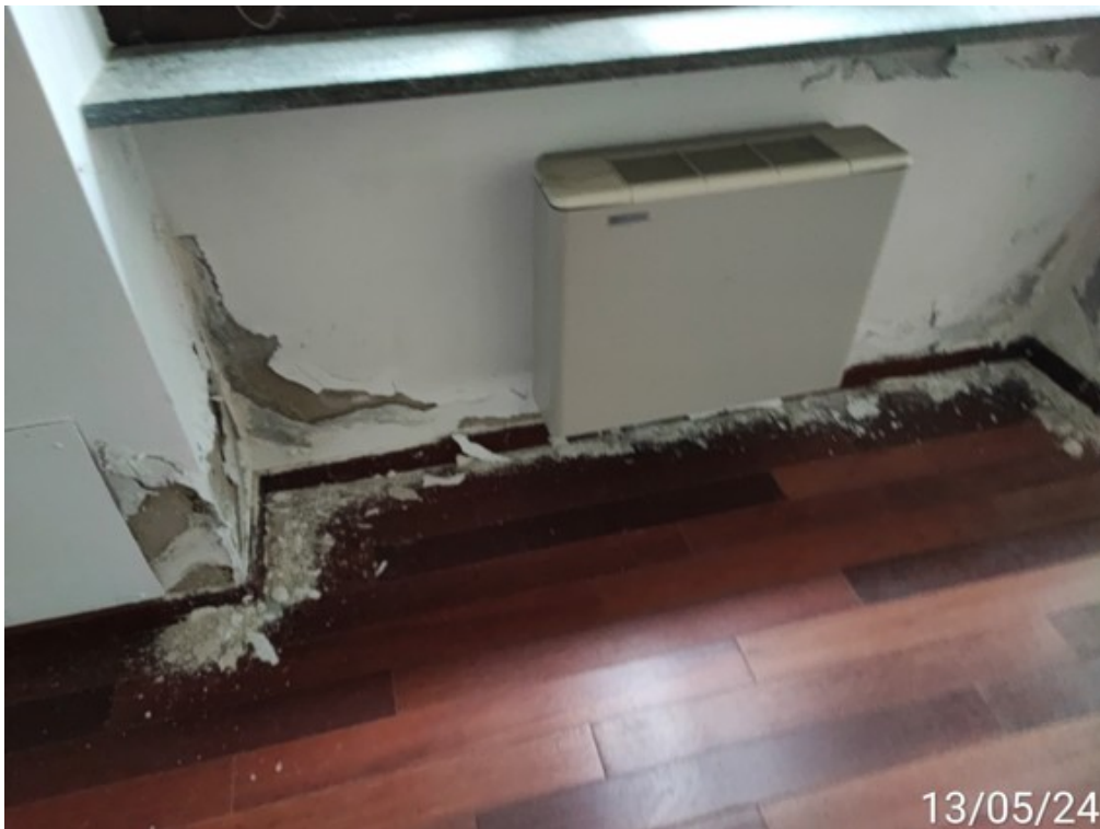
Fotografia E.22 - 23 Particolare tracce notevoli di umidità da infiltrazioni
