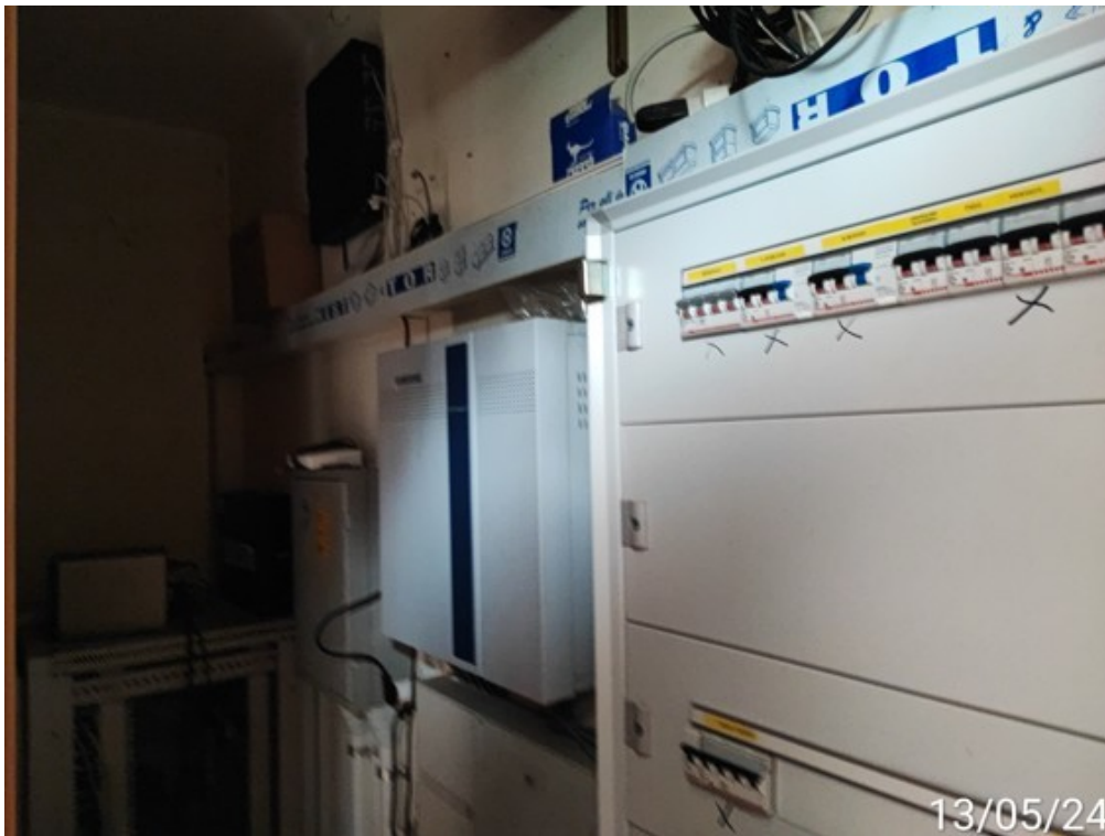
Fotografia E.23 - 24 Quadri Elettrici e centraline Uffici
