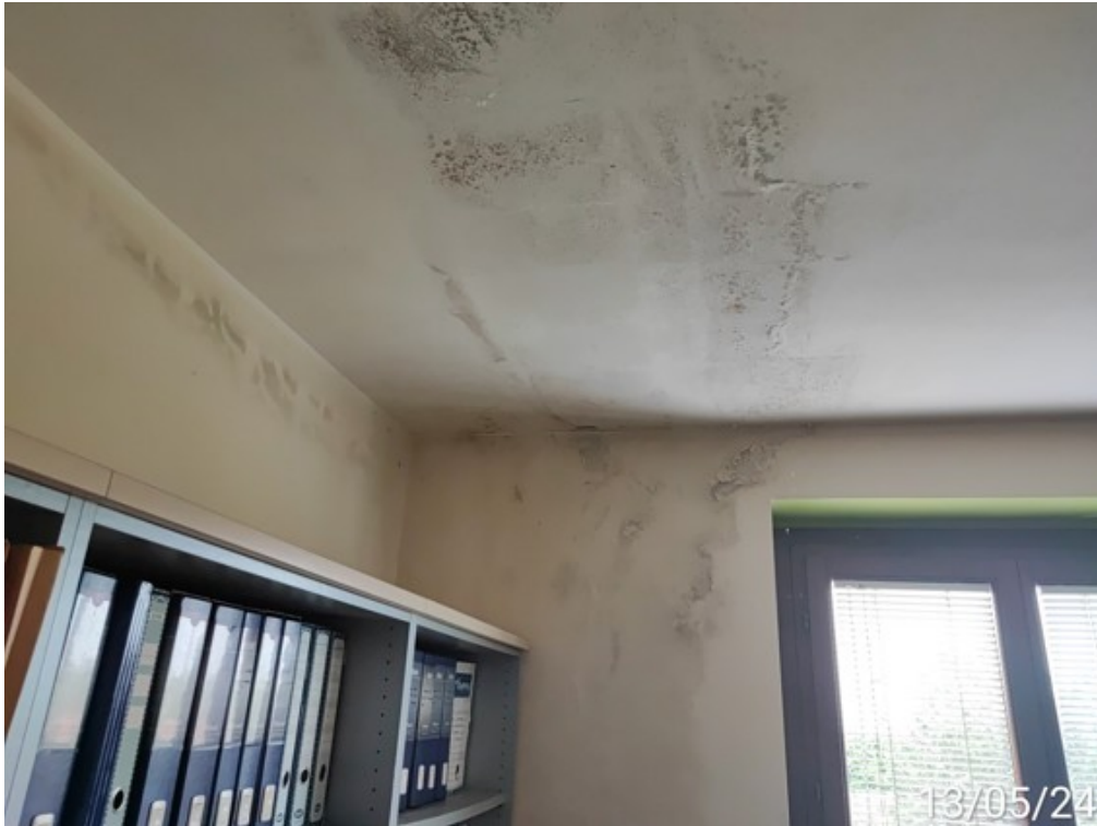
Fotografia E.21 - 22 Particolare tracce di umidità da infiltrazioni
