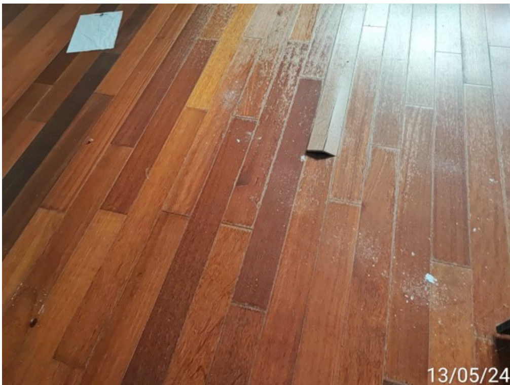
Fotografia E.18 - 19 Particolare pavimento in legno danneggiato
