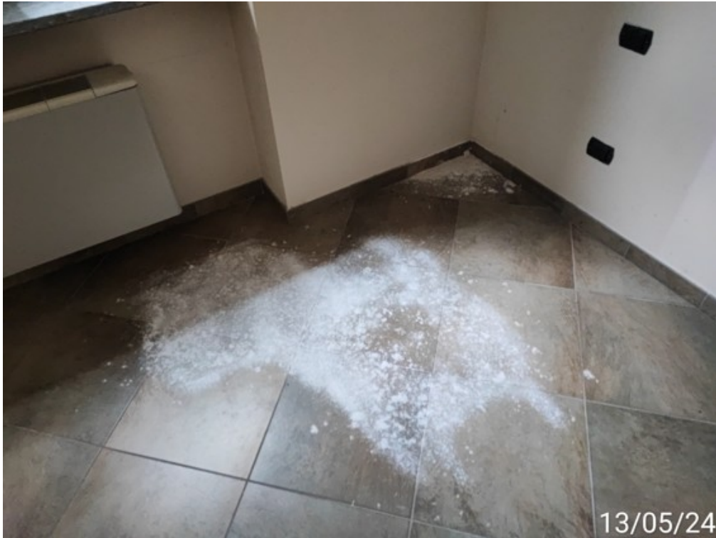
Fotografia E.35 - 36 Particolare infiltrazioni Appartamento
