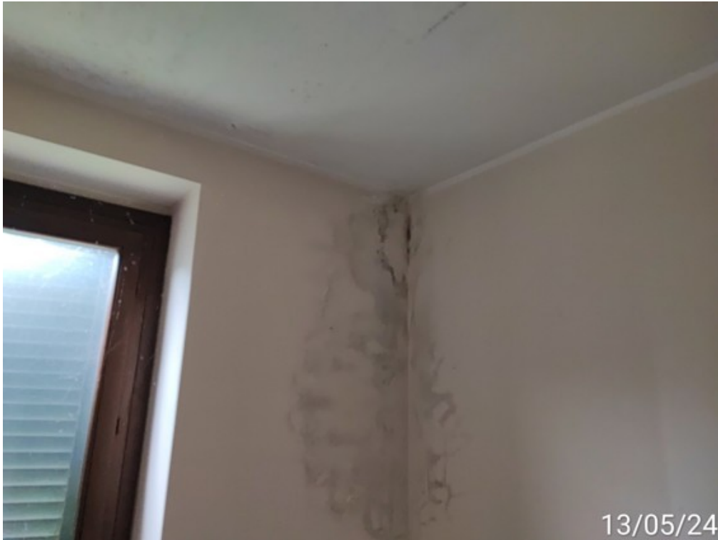
Fotografia E.33 - 34 Particolare infiltrazioni Appartamento
