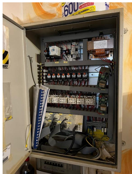
Quadro elettrico generale
