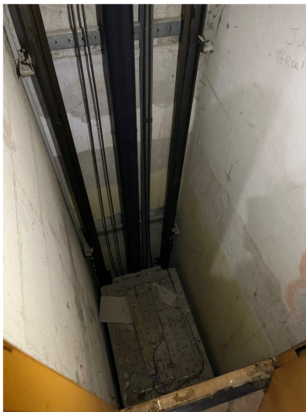
Locale tecnico piattaforma elevatrice
