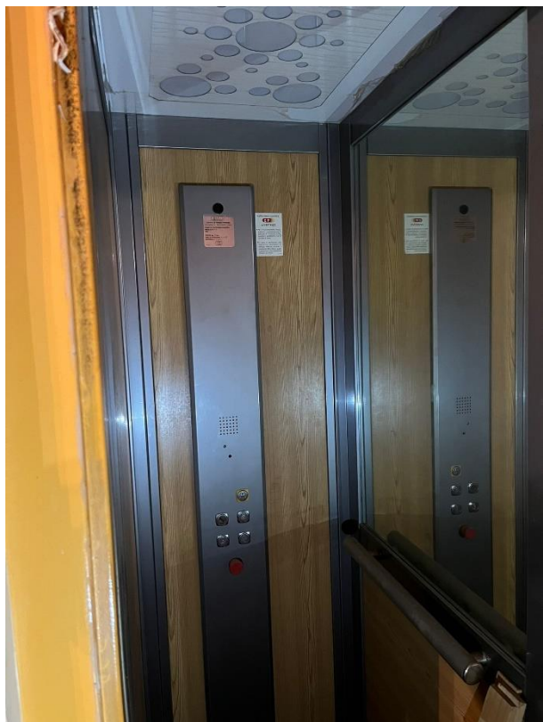
Vano interno piattaforma elevatrice
