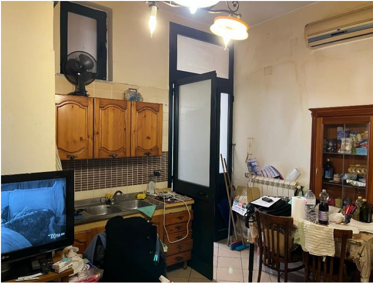
Vista camera con indicazione della collocazione del condizionatore
