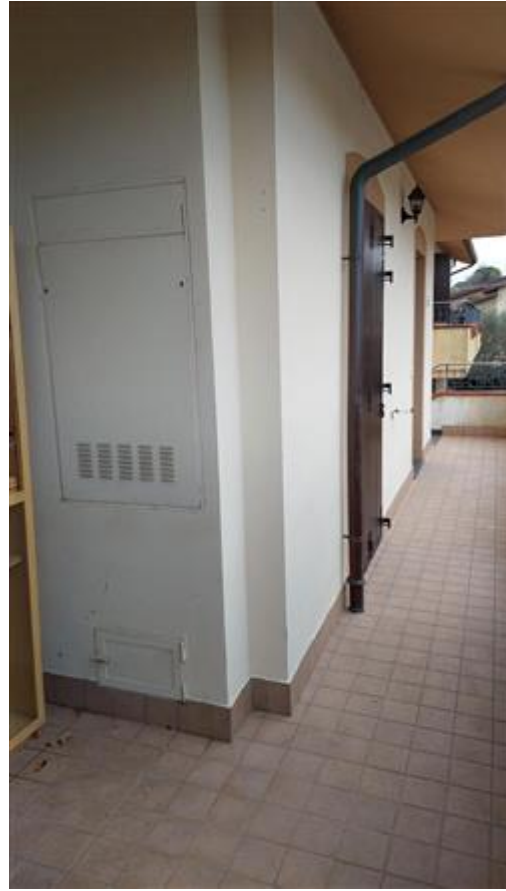
Terrazzo e caldaia
