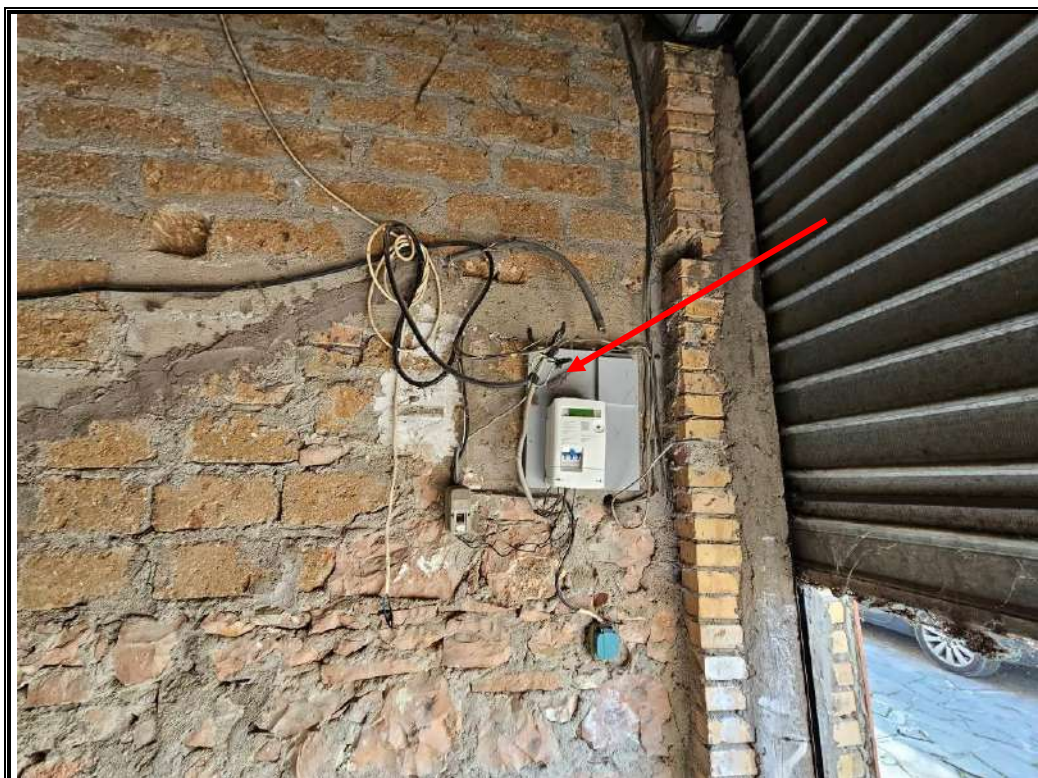
Foto n. 8 Particolare dell'impianto elettrico che alimenta la pompa del pozzo.
