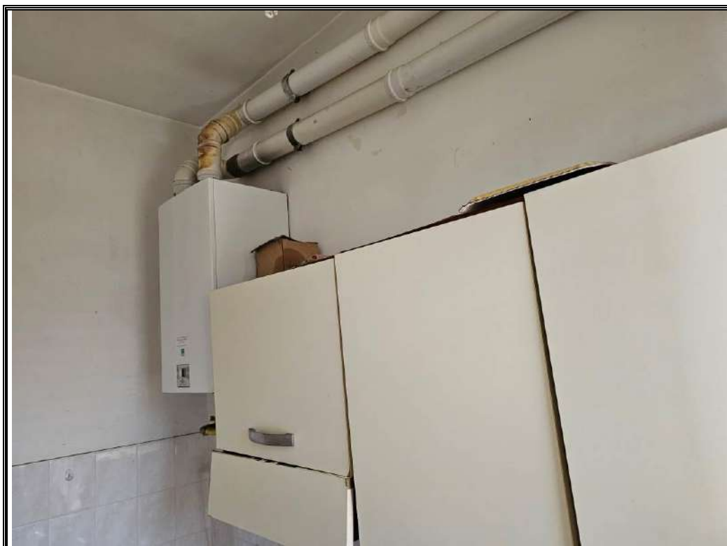
Foto n. 15 Particolare della caldaia ubicata nel cucinotto.
