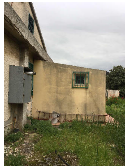
Volume abusivo a nord
