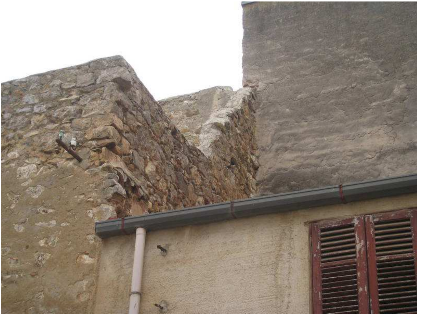
Foto n. 7. Dettaglio delle murature al secondo piano dopo il crollo del tetto.
