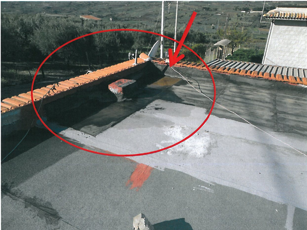
Copertura corrispondente con l'angolo in cui ci sono tracce di umido (presenza di ristagno di acqua)
