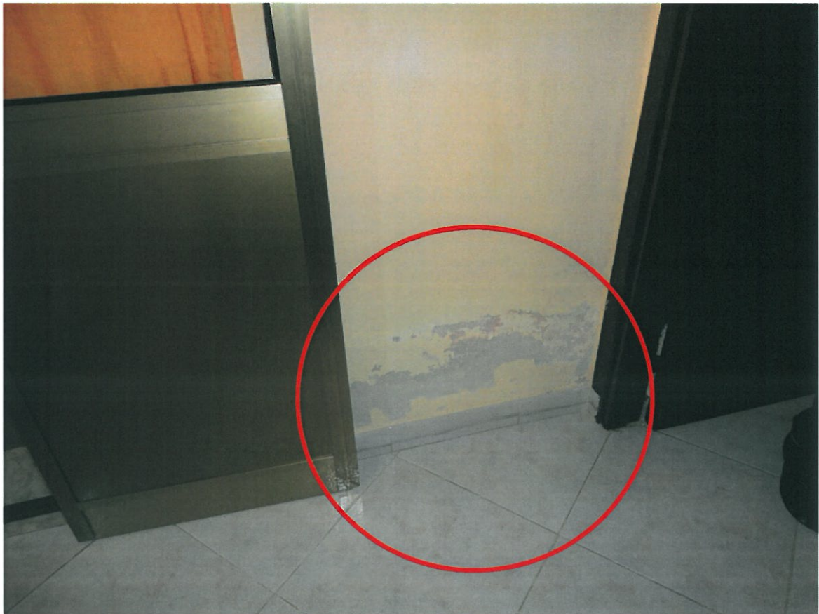
Porzione di parete interna nei pressi dell'ingresso principale con lieve umidità di risalita
