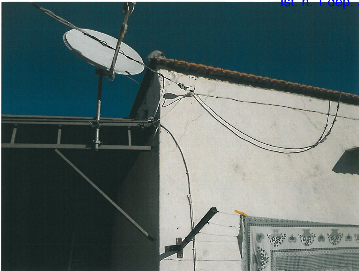
Vista del prospetto esterno (angolo oggetto di tracce di umido)
