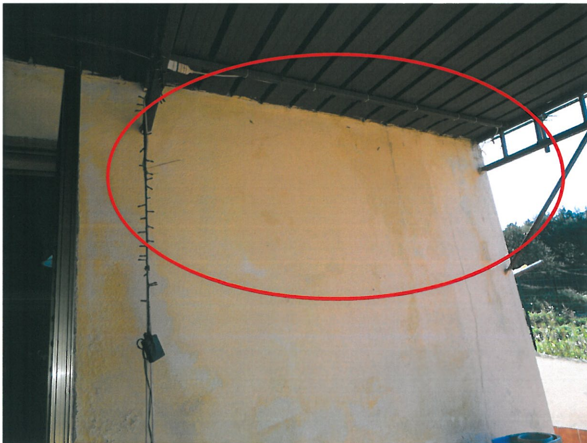
Vista del prospetto principale (corrispondente con l'angolo in cui sono presenti tracce di umido)
