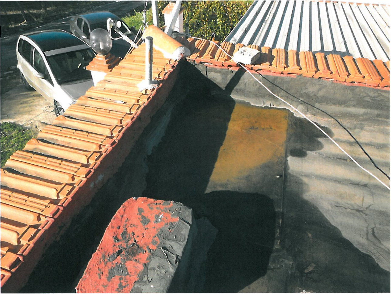
Copertura corrispondente con l'angolo in cui ci sono tracce di umido (presenza di ristagno di acqua)
