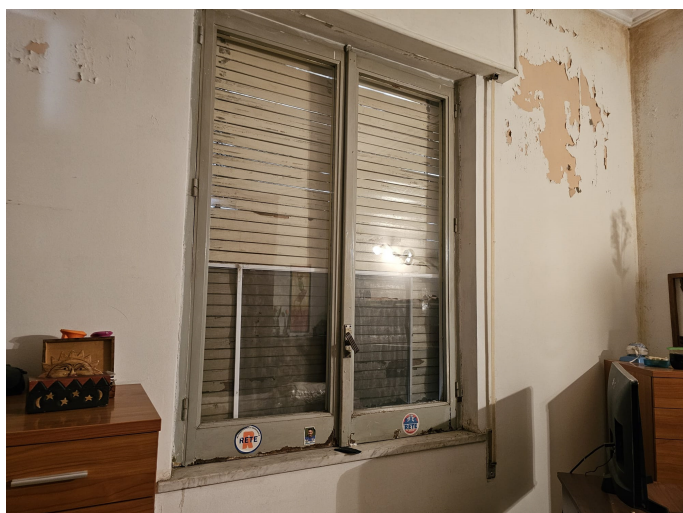
Foto 27 camera 03 infissi vetusti e segni di ammaloramento
