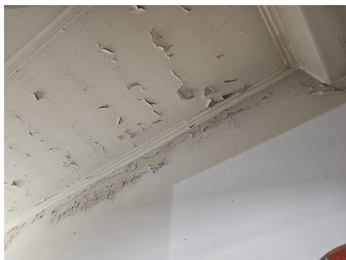
Foto 28 segni di ammaloramento sul soffitto del corridoio
