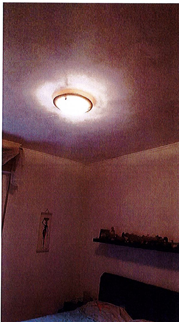
Altra vista del soffitto della camera matrimoniale, con alonature ed infiltrazioni
