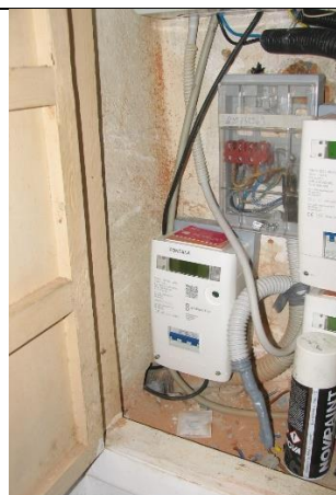
Contatore elettrico appartamento
