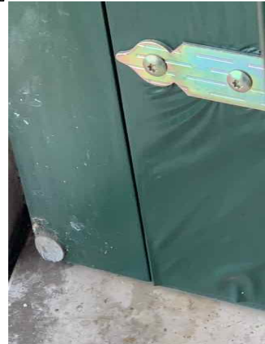
criticità serramenti esterni
