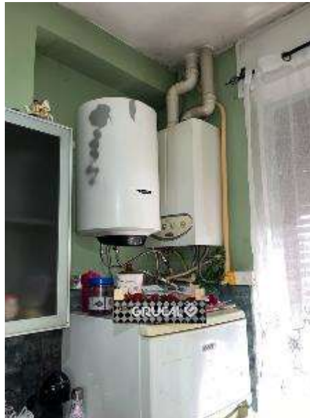
Veduta interna caldaie cucina
