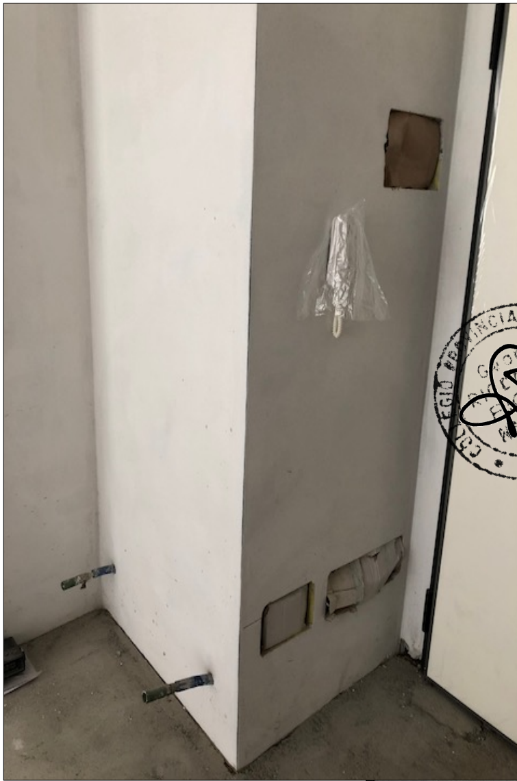
FOTO N° 17: Particolare impianti non realizzati.
