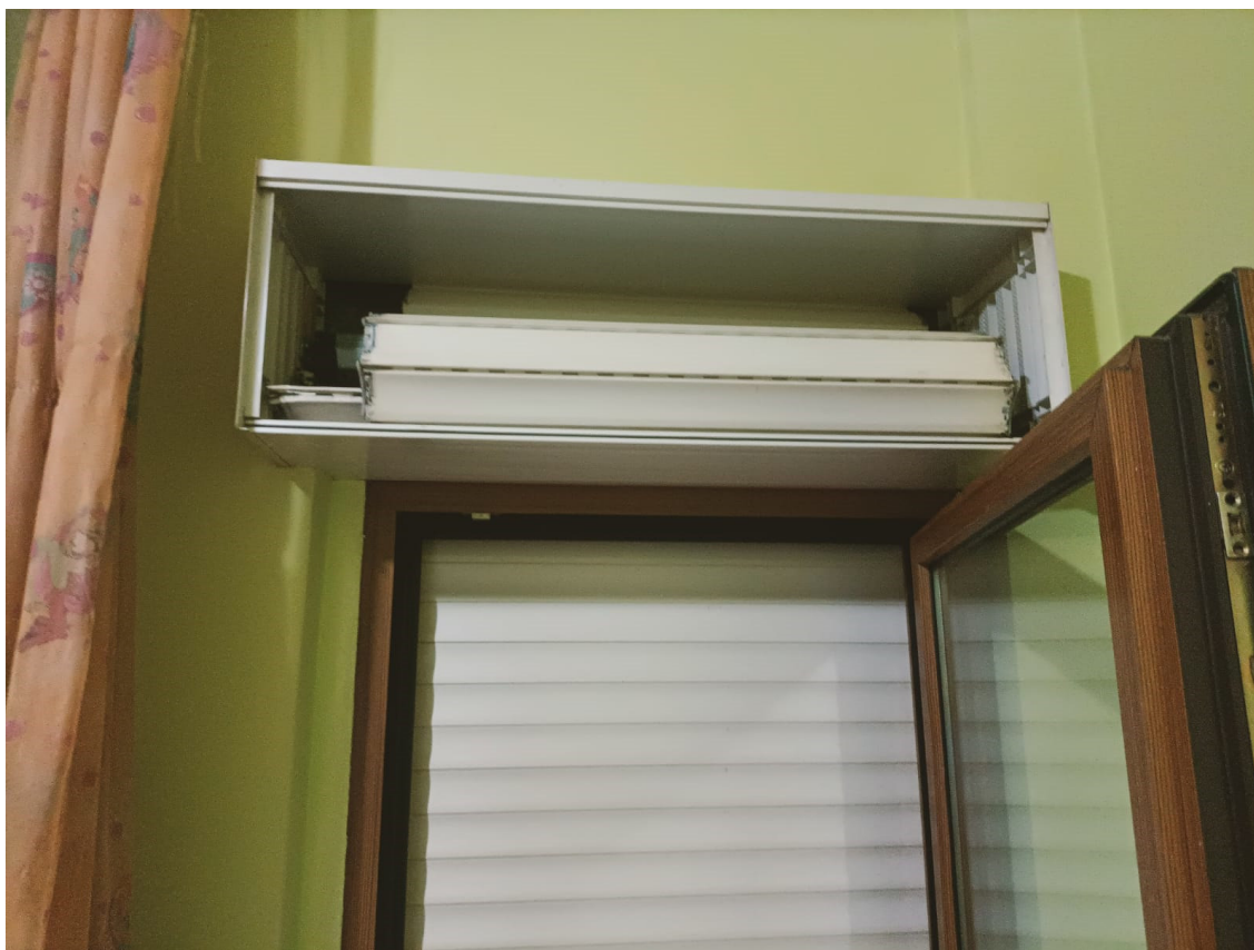
Rottura tapparella elettrica
