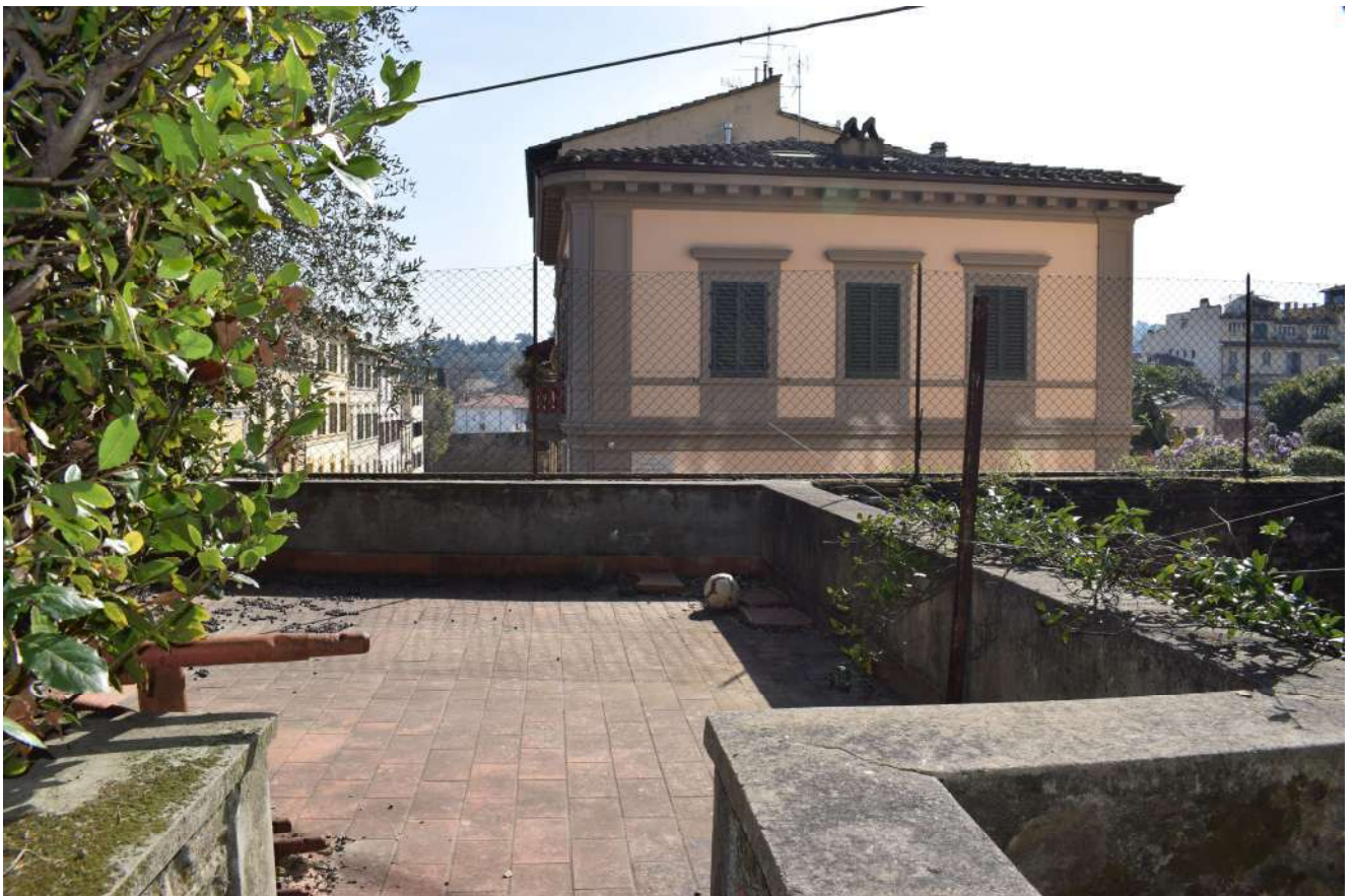
Foto n. 9_ Sopralluogo del 01/04/2019 La copertura a terrazza dell'autorimessa con vista su via Pindemonte
