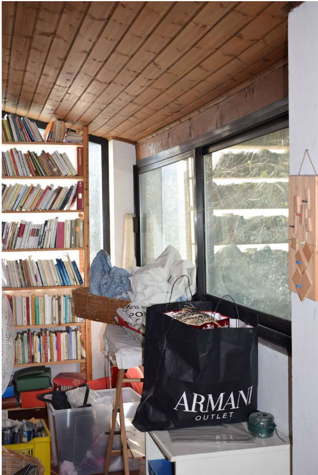
Foto n. 28_ Sopralluogo del 01/04/2019 Edificio part.Ila 133: piano primo, la veranda condonata
