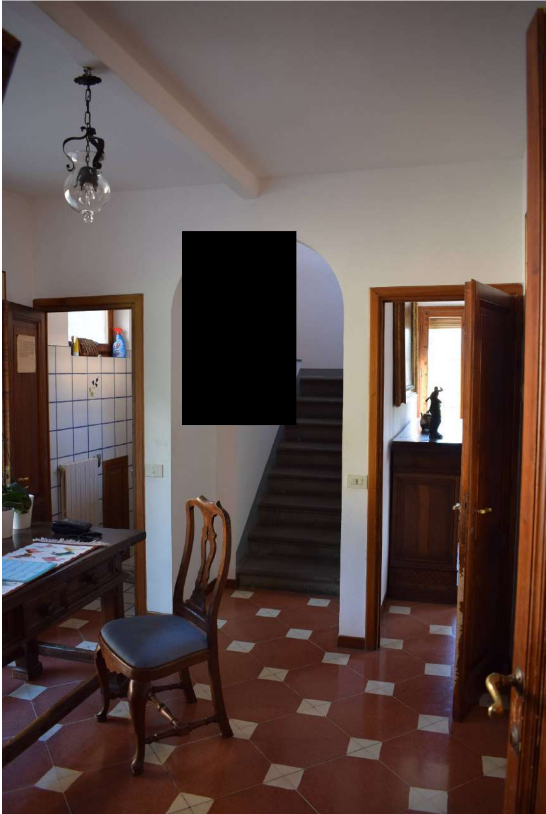
Foto n. 24_ Sopralluogo del 01/04/2019 Edificio part.IIa 133: il disimpegno con vano scale per accesso al piano primo e a lato il bagno sottoscala dotato di finestra alta
