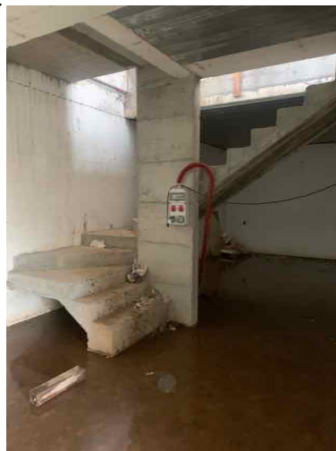
scala interna (presenza d'acqua)
