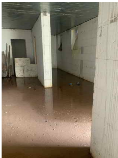
ripostiglio (presenza d'acqua)
