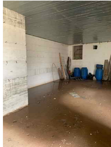
garage (presenza d'acqua)
