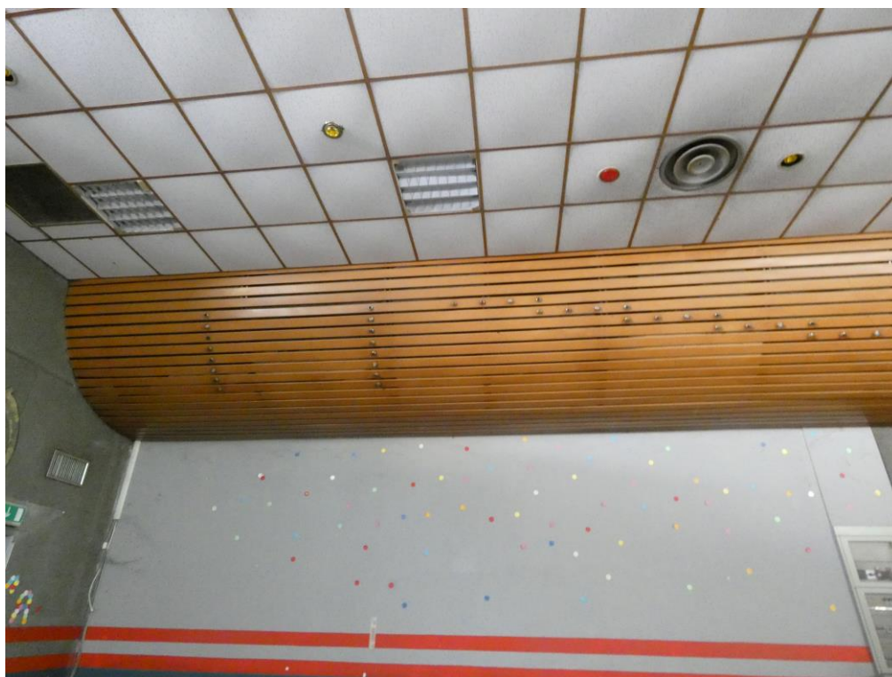
Presenza esterna 33 – Vista Interna della sala circolo: Intradosso del controsoffitto del solaio Piano Primo: i due diversi controsoffiti
