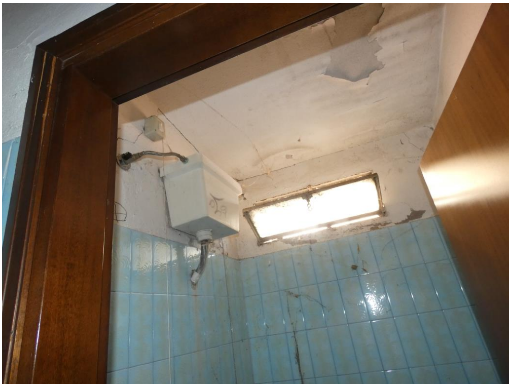
Presenza fotografica 42 – Vista Interna W.C.: Intradosso del solaio Piano Primo con dettaglio dello scrostamento dell'intonaco viziato da infiltrazione delle acque meteoriche dalla copertura del Piano Primo
