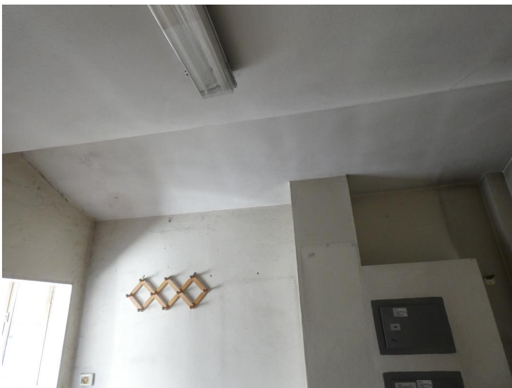
Presafotografica 71 - Vista Interna Ufficio: Diverse quote dell'intradosso del solaio di copertura
