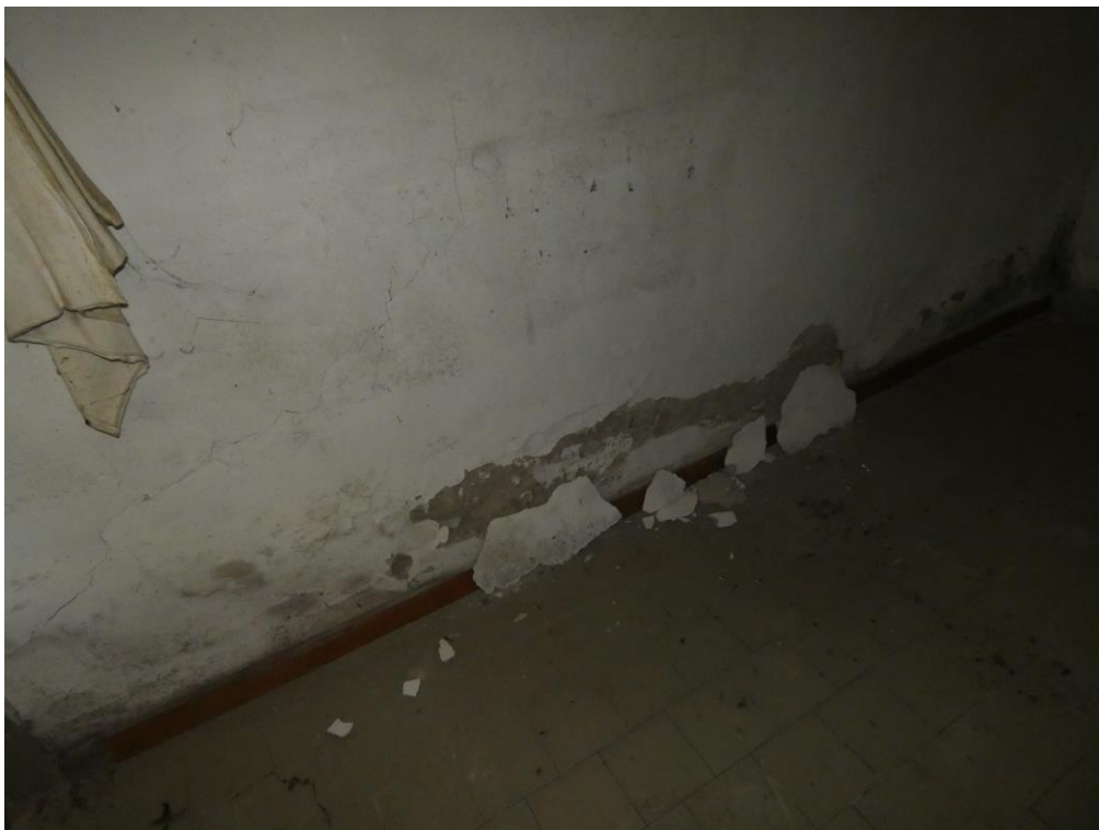
Presafotografica 47 – Vista Interna ripostiglio: Ammaloramento dell'intonaco
