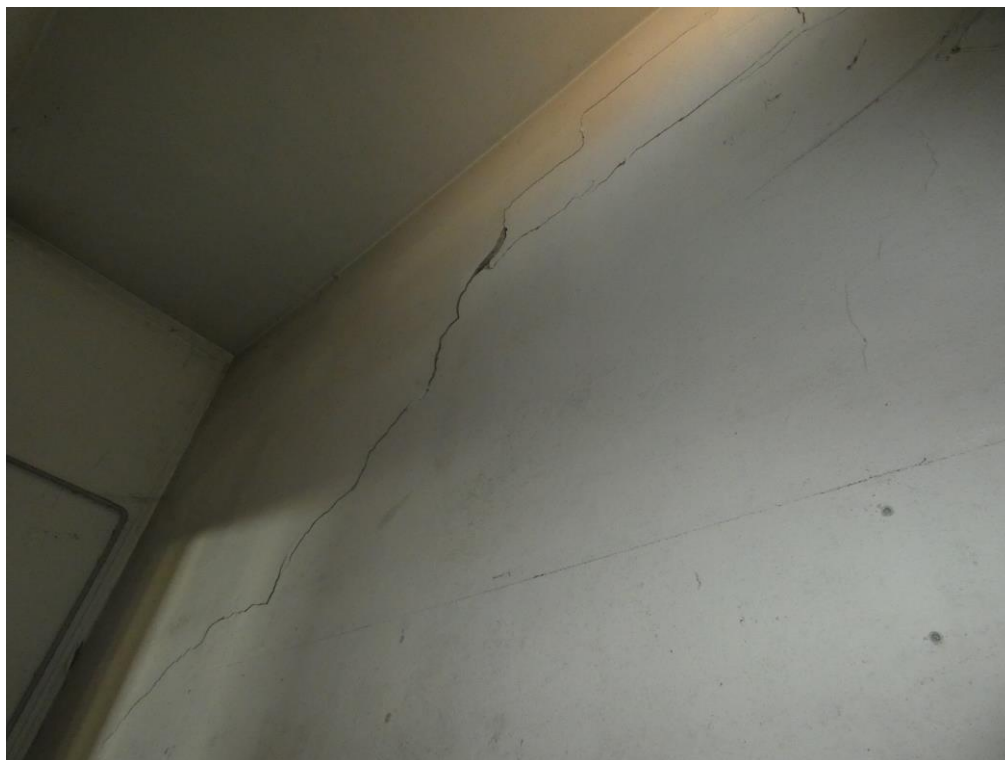
Presenza fotografica 50 – Vista Interna ripostiglio: Presenza di stato fessurativo su muratura portante
