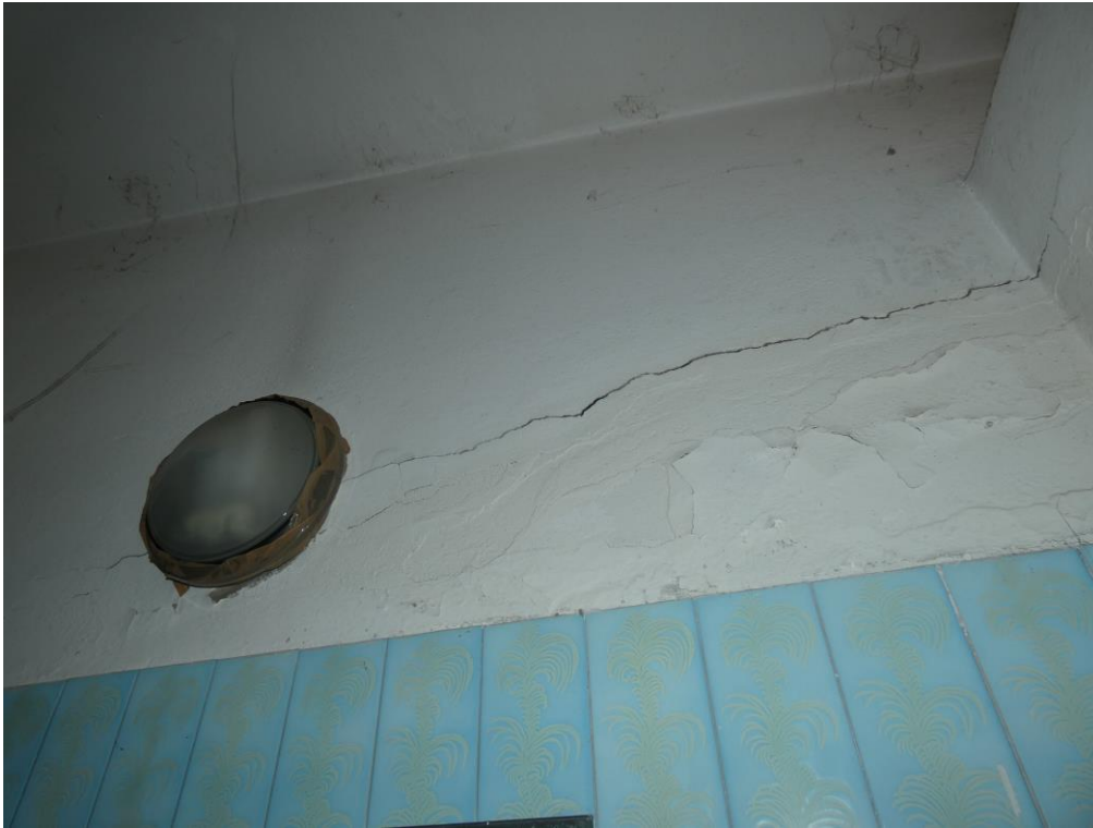
Presenza fotografica 43 – Vista Interna Antibagno: Dettaglio della presenza di stato fessurativo su paramento murario
