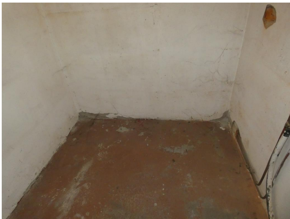
Presenza fotografica 22 – Vista Interna ripostiglio: Dettaglio dello scrostamento dell'intonaco viziato dalla presenza della risalita capillare dell'umidità dal terreno
