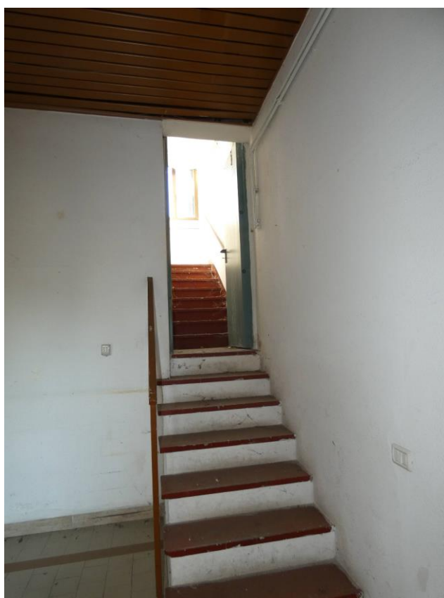
Presenza fotografica 63 – Vista Interna Ingresso: Rampa scale per l'accesso al Piano Primo
