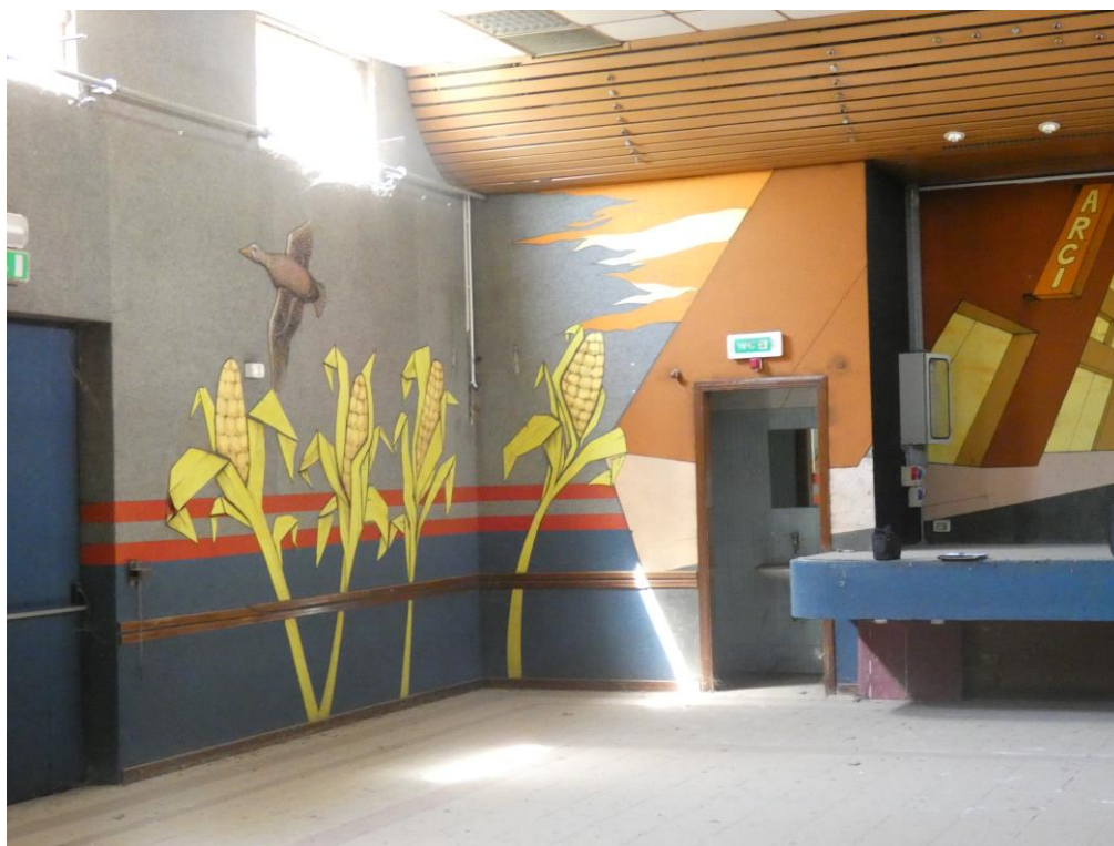
Presa fotografica 35 – Vista Interna della sala circolo: Intradosso del controsoffitto del solaio Piano Primo: i due diversi controsoffitti
