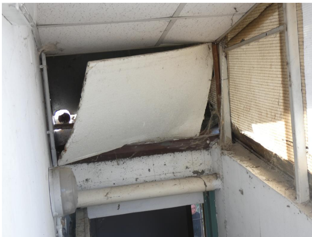
Presafotografica 74 – Vista Interna Vano scala: Dettaglio controsoffitto pericolante
