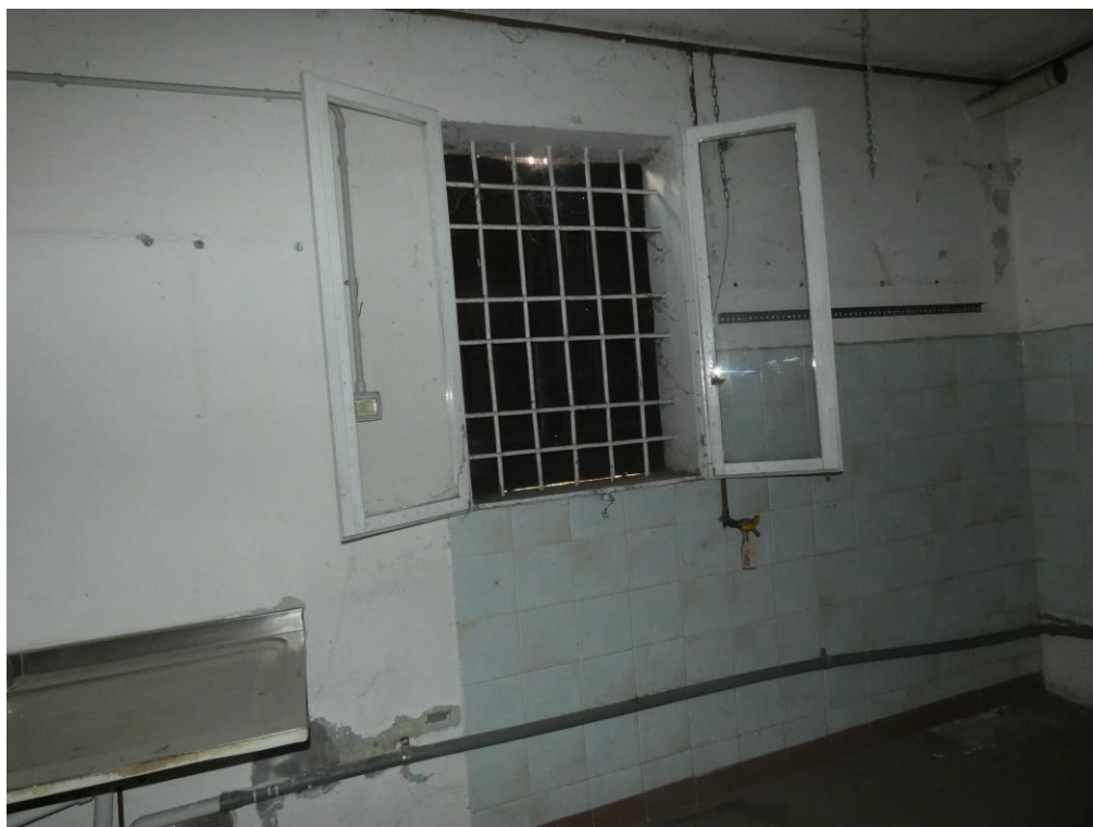
Presenza fotografica 16 – Vista Interna: Finestra cucina con particolare dello scrostamento dell'intonaco viziato dalla presenza della risalita capillare dell'umidità dal terreno
