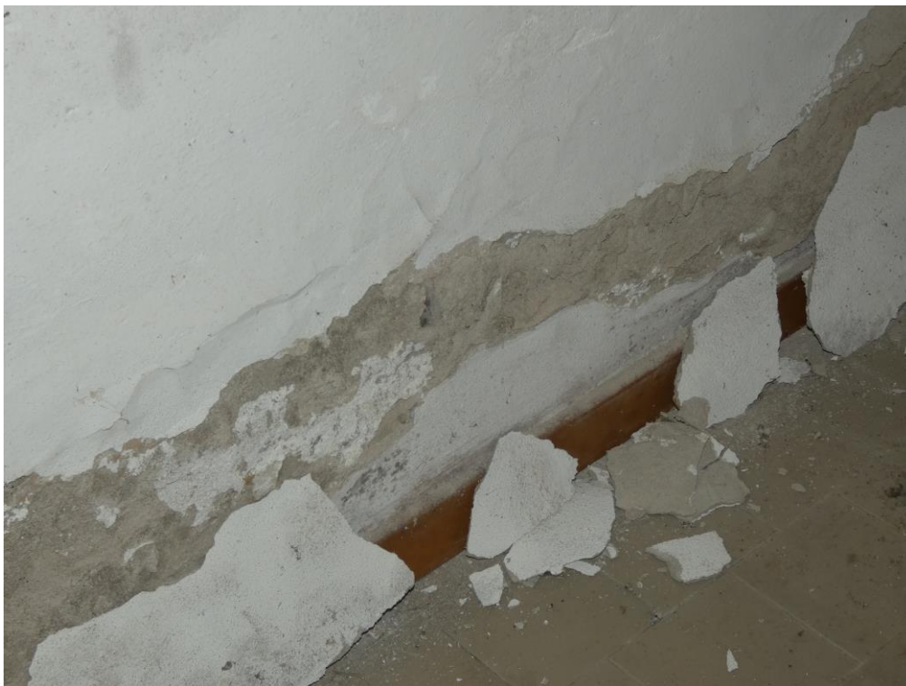
Presa fotografica 48– Vista Interna ripostiglio: Dettaglio ammaloramento dell’intonaco viziato dalla presenza della risalita capillare dell’umidità dal terreno
