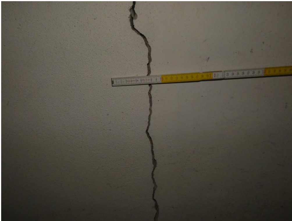
Presenza esterna 52 – Vista Interna ripostiglio: Dettaglio dello stato fessurativo
