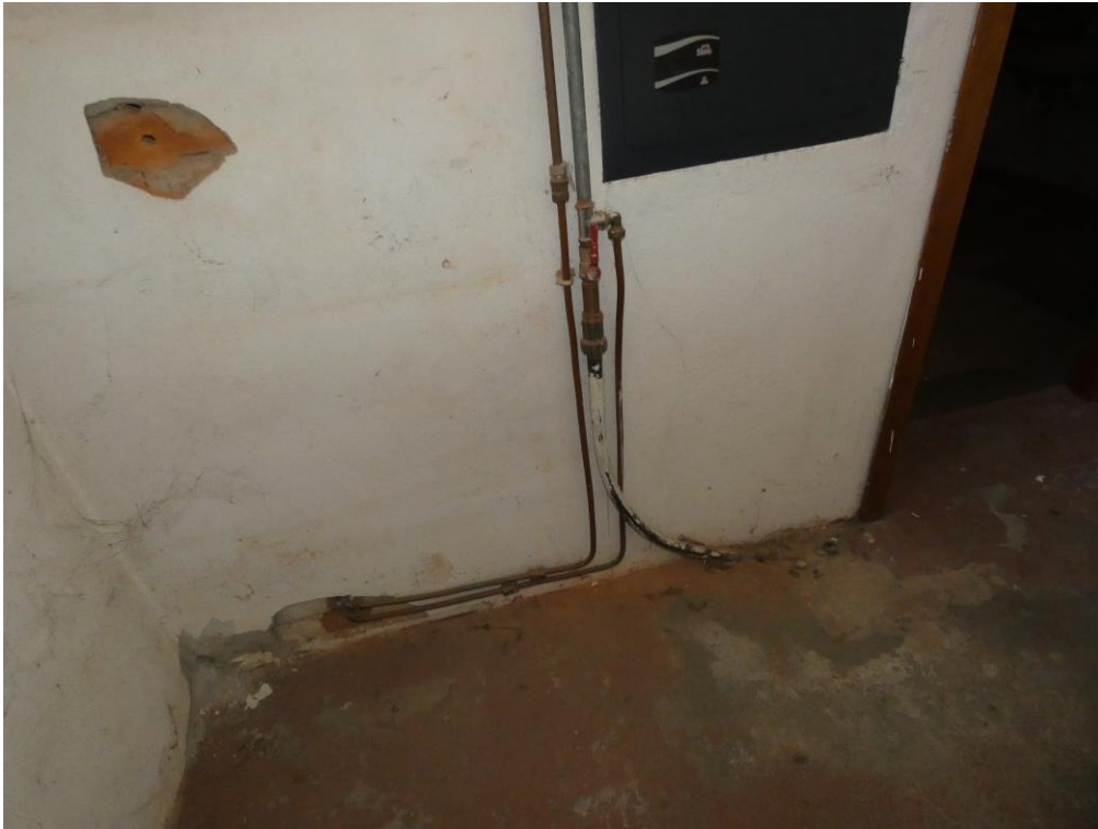
Presenza fotografica 23 – Vista Interna ripostiglio: Dettaglio impianti esistenti
