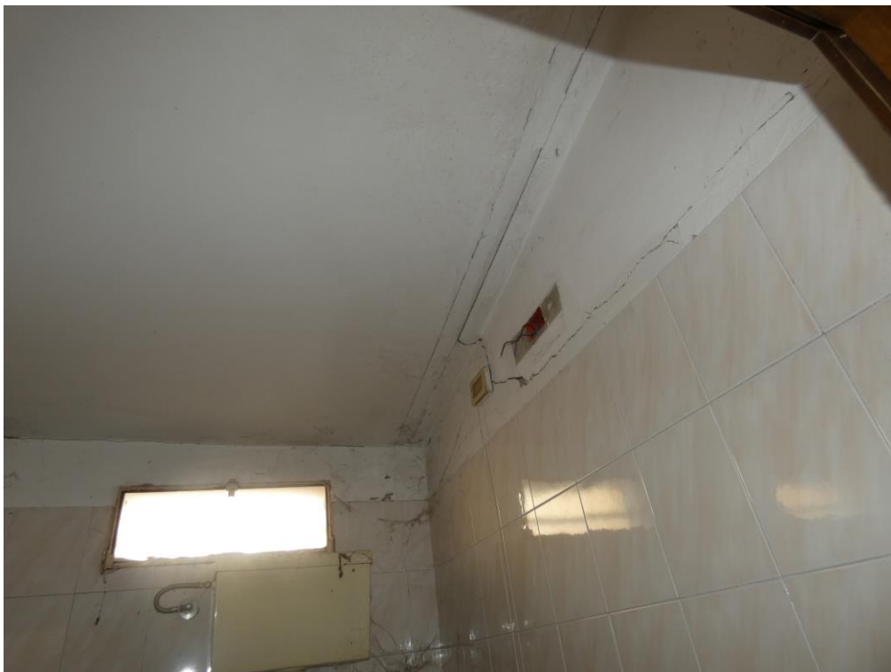
Presa fotografica 59 – Vista Interna W.C.: Dettaglio intradosso del solaio Piano Primo, con presenza di stato fessurativo su paramento murario
