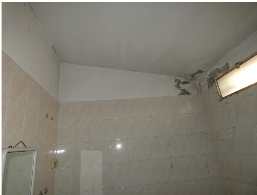
Presafotografica 60 – Vista Interna W.C.: Intradosso del solaio piano primo – Dettaglio ammaloramento dell’intonaco viziato da infiltrazione delle acque meteoriche dalla copertura del Piano Primo
