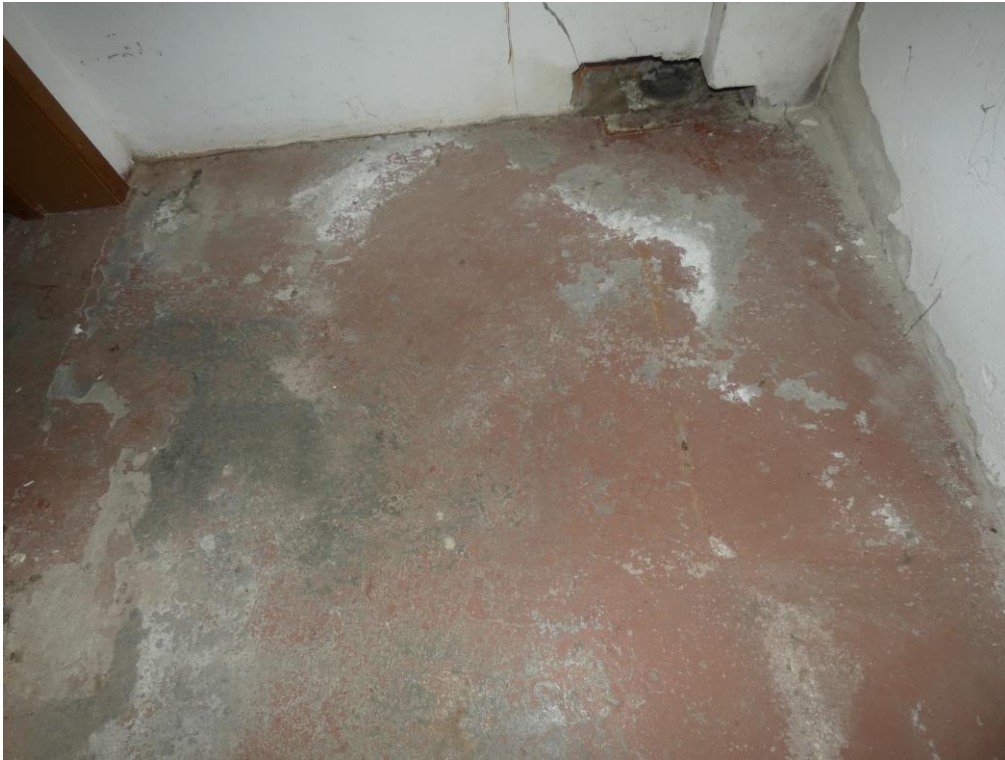
Presenza fotografica 25 – Vista Interna ripostiglio: Particolare dello scrostamento dell’intonaco viziato dalla presenza della risalita capillare dell’umidità dal terreno e dettaglio di una finitura interna
