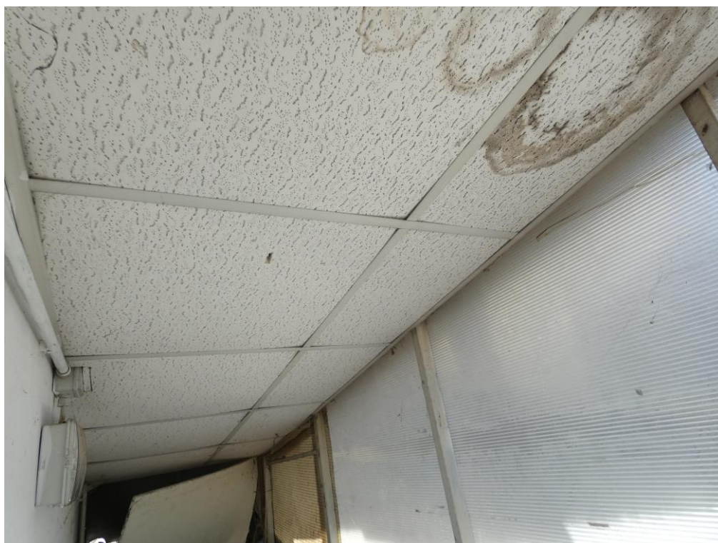
Presenza fotografica 73 – Vista Interna Vano scala: Dettaglio intradosso del controsoffitto del solaio ammalorato
