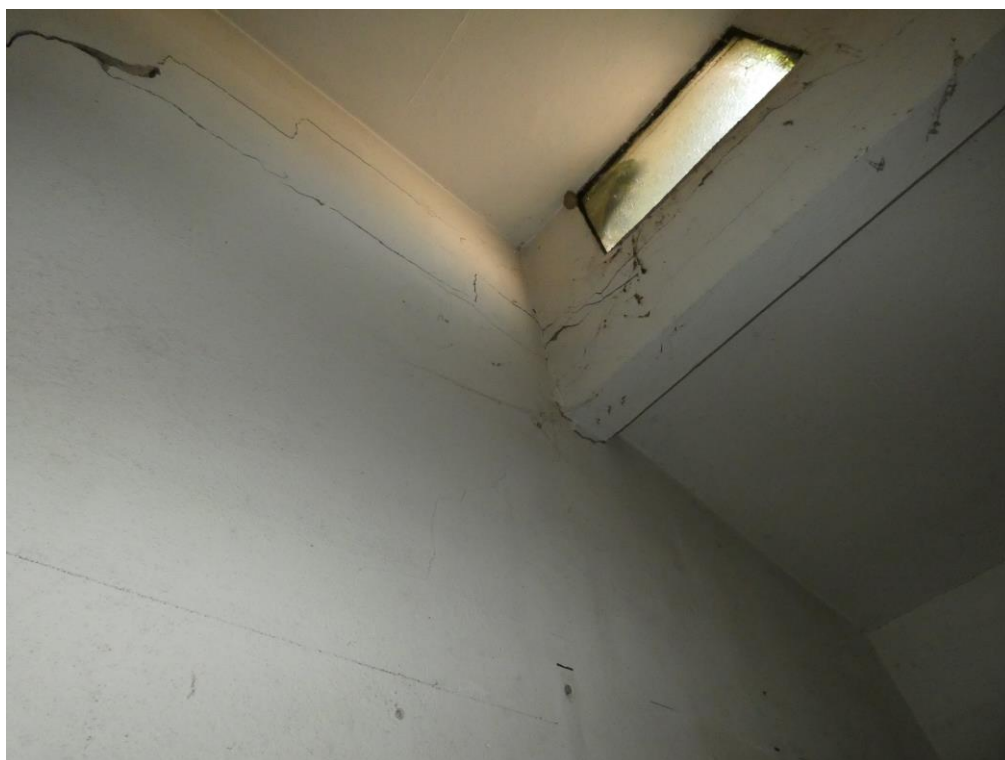
Presenza fotografica 51 – Vista Interna ripostiglio: Presenza stato fessurativo su muratura portante
