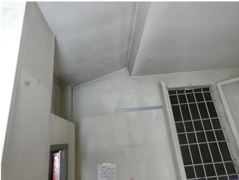
Presa fotografica 69 - Vista Interna Ufficio: Diverse quote dell'intradosso del solaio di copertura
