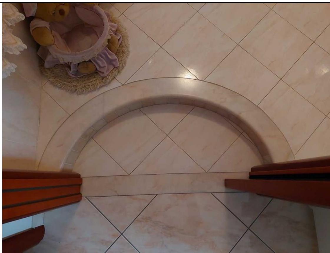
30. Piano secondo, bagno (vano n. 9 nella planimetria dello stato di fatto, all. 3, tav. 1). Gradino posto all'ingresso del vano.
