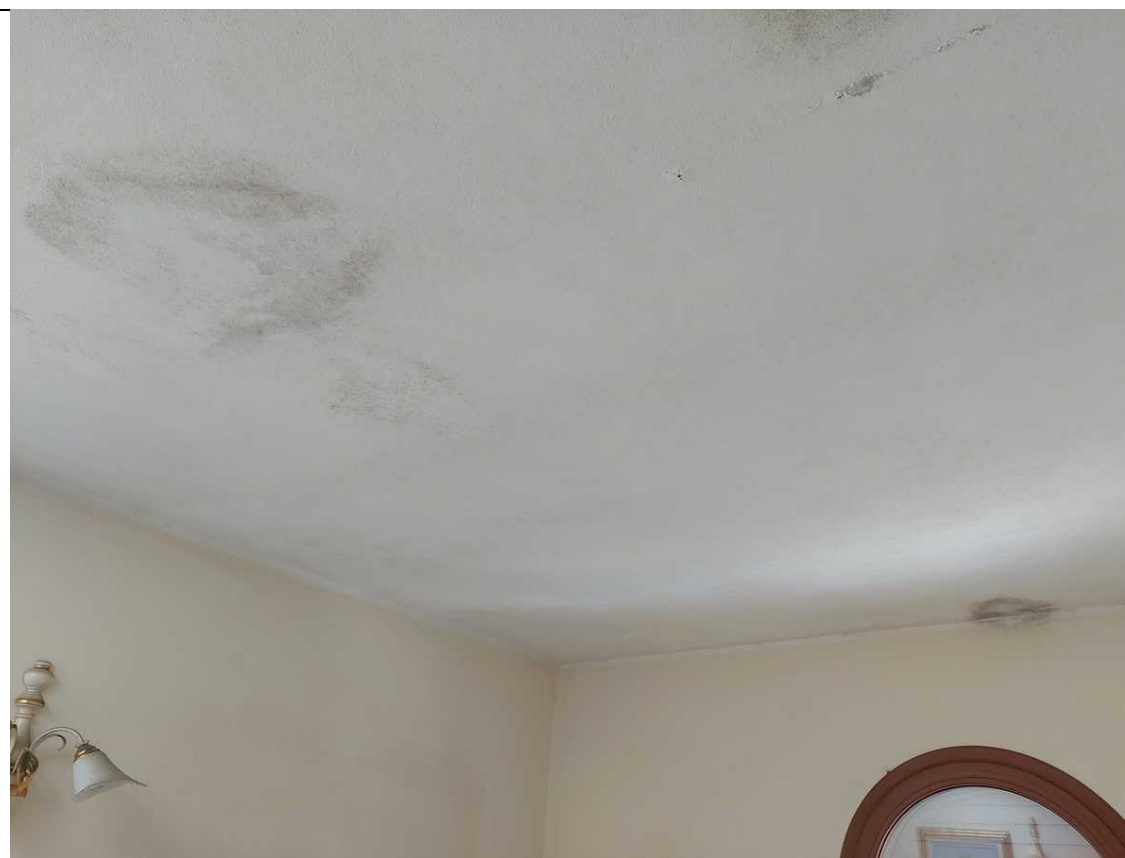
22. Piano secondo, disimpegno (vano n. 5 nella planimetria dello stato di fatto, all. 3, tav. 1). Sono presenti evidenti danni alla pittura del soffitto presumibilmente a causa di infiltrazioni dalla copertura.
