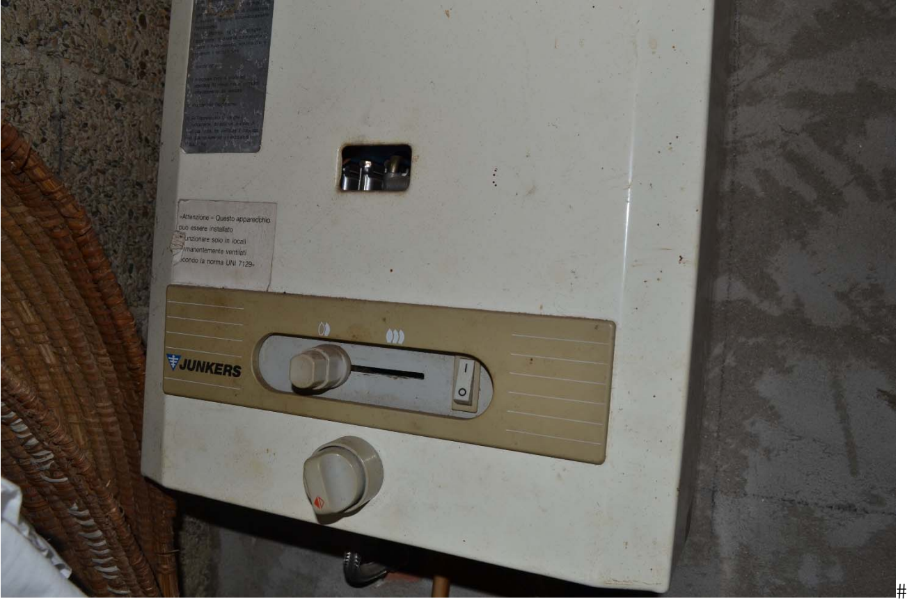
19. Particolare caldaia per acqua calda sanitaria
