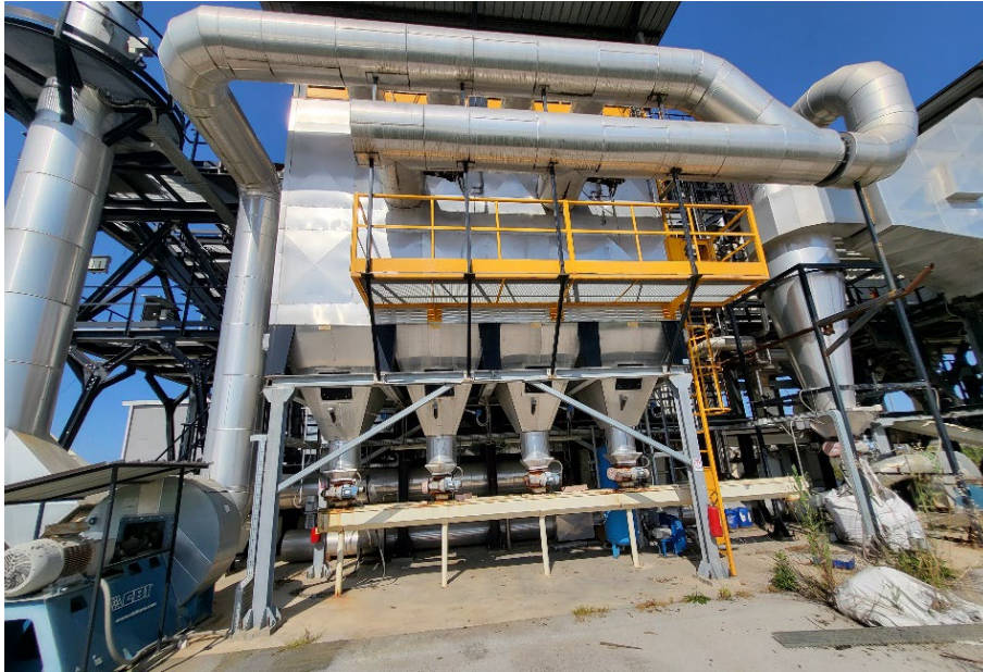
Foto 8: filtro a maniche
