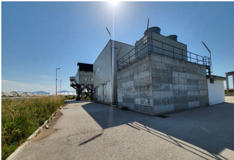
Foto 11: torri evaporative e locale pompe acqua torre
