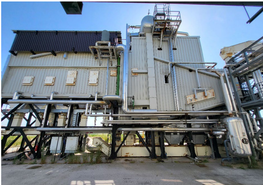
Foto 7: caldaia a biomassa
