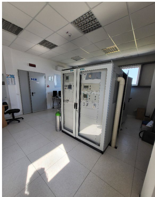
Foto 3: sala controllo piano primo
