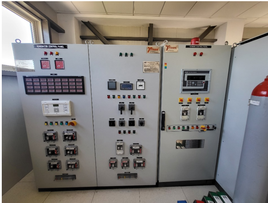
Foto 4: particolare sala controllo piano primo
