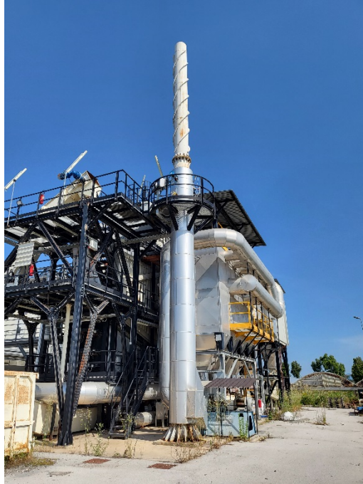
Foto 10: camino caldaia a biomassa
