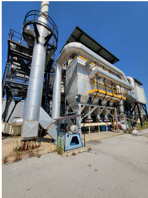
Foto 9: ventilatore estrazione fumi
