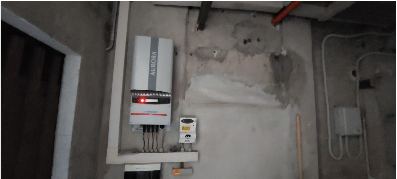
FOTO 29 – Inverter fotovoltaico condominiale
