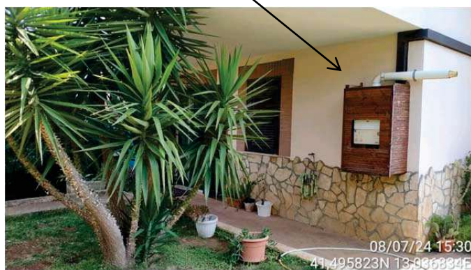
CALDAIA A GPL
