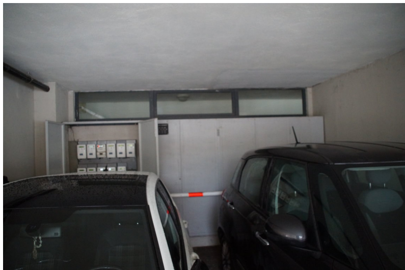
Foto n°16: particolare dell'alloggiamento dei contatori della luce posti lungo il piano terra dello stabile nella parte esposta a Sud.
