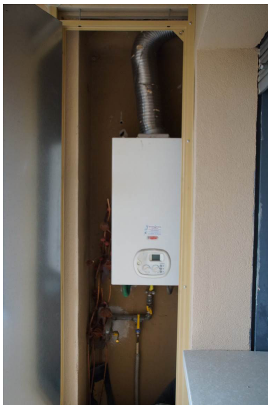
Foto n°13: particolare della caldaia a gas metano.
