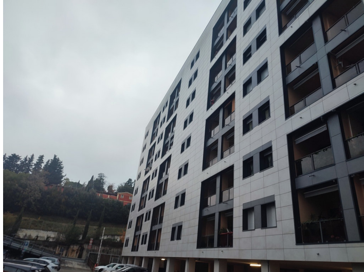
Foto n°1: vista lato Sud del fabbricato, si noti il cappotto termico realizzato di recente.
