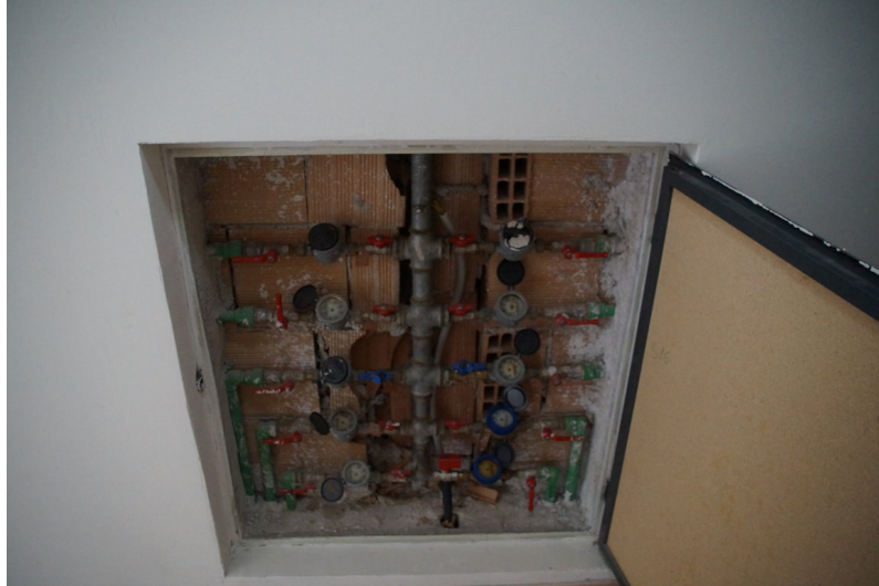
Foto n°15: particolare dell'alloggiamento dei contatori dell'acqua posti lungo il piano ottavo.
