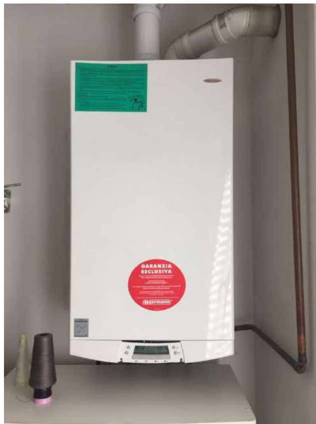
Foto 10 – Caldaia Piano Terra
