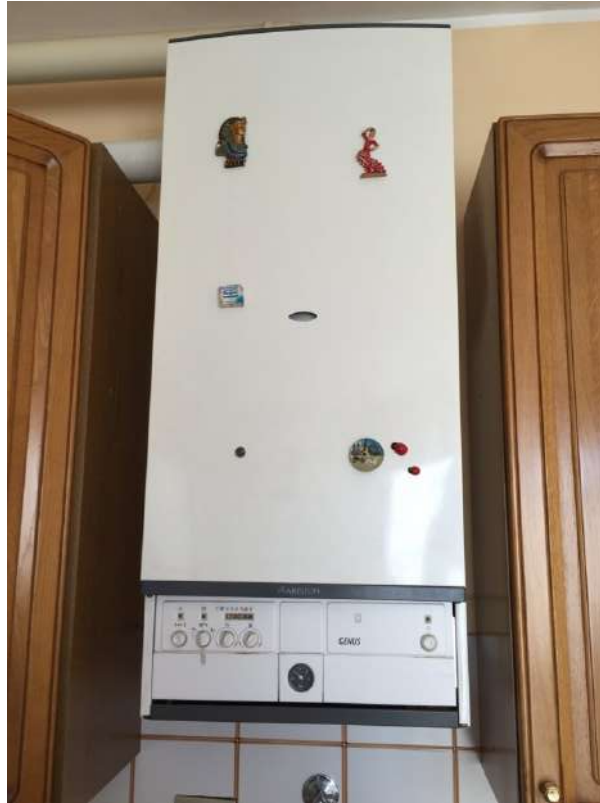
Foto 05 – Caldaia Piano Primo
